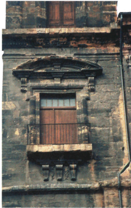
1. Aspecto del balcón izquierdo de la fachada, con abundantes pátinas y costras negras.
