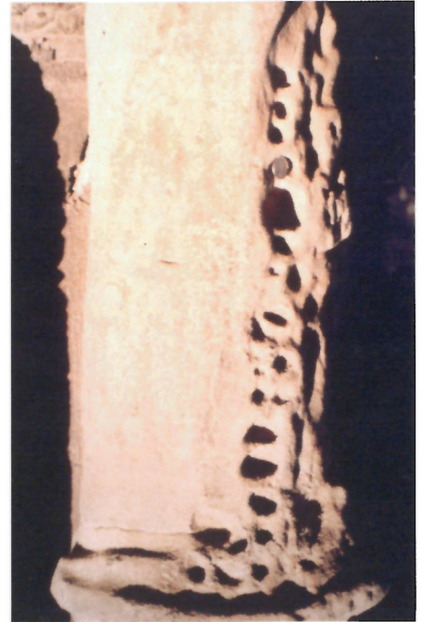
21. Alveolización. Palacio de Revillagigedo (Gijón)
