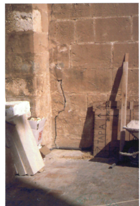
22. Fisuras. Catedral de Palma de Mallorca
