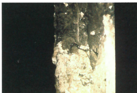
19. Desmoronamiento. Claustro de la catedral de Burgos
