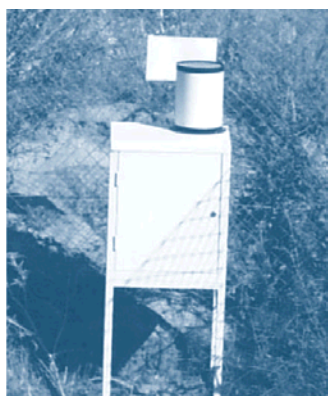
Figura 6. Armario metálico para el data-logger y la batería. Pluviómetro instalado
