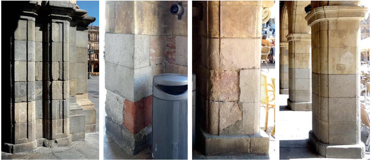
Figura 29. Casa Consistorial. Sustituciones de sillares, posiblemente del siglo XIX. Figura 30 y 31. Diversos parches de sillares, posiblemente del siglo XX. Figura 32. Perfección en todas las juntas, posiblemente de la sillería original.
