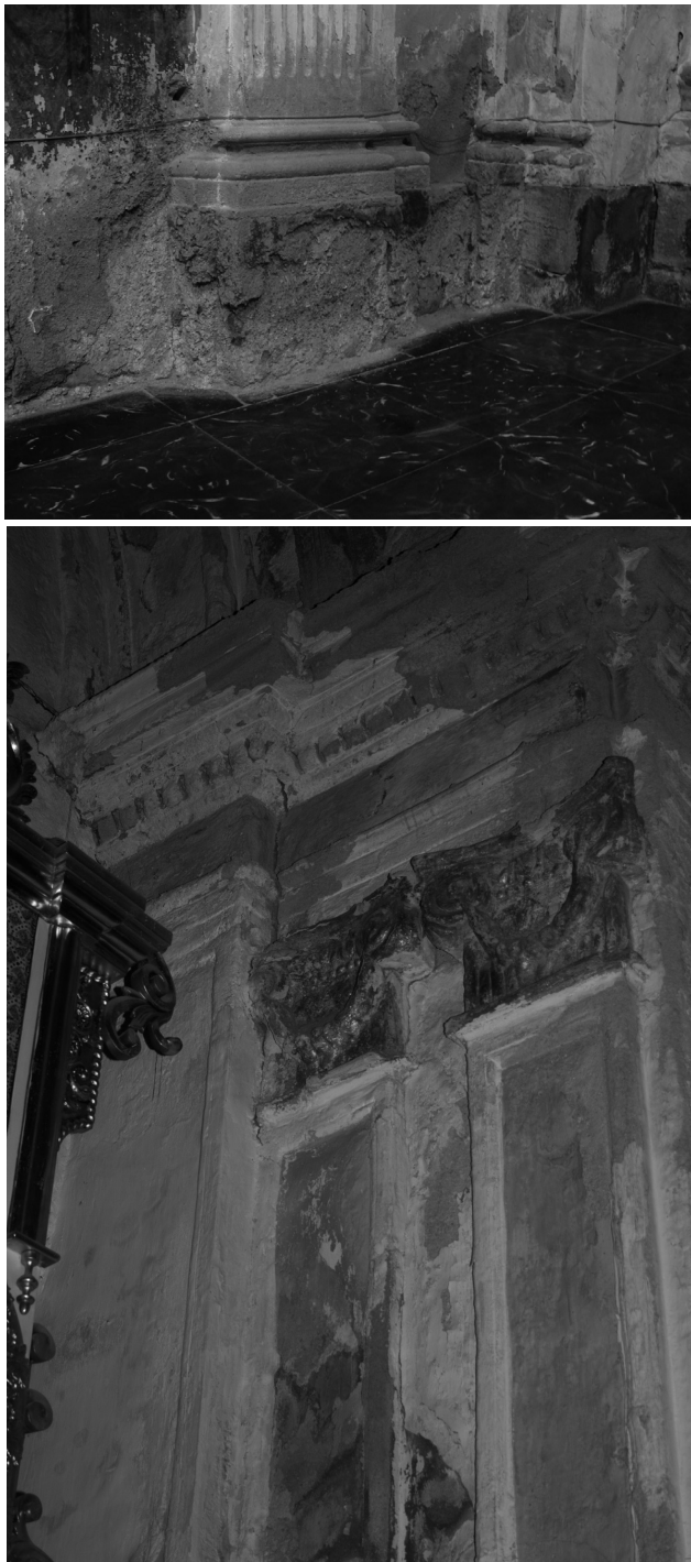
Figura 6. Detalles del estado de degradación de los acabados interiores (Mileto & Vegas)
