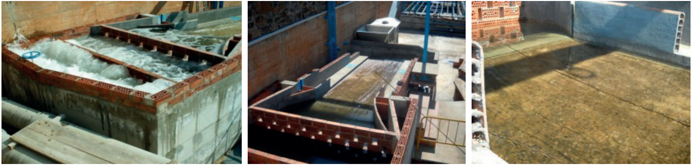
Figura 2 | Plataforma en operación. Entrada uniforme de un caudal de 100 L/s.
