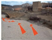
4.- Zona de Riesgo 1. Efecto de ensanchamiento del cauce. Tendencia a anegarse la margen derecha en caso de crecidas. Se crean corrientes en forma de remolino en torno a la base del puente.
