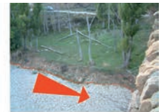
7.- Zona de Riesgo 2. Erosión de bordes con arrastre de materia. Peligro de anegación de las áreas anexas así como arrastre de la masa forestal por pérdida del sustrato sustentante.
