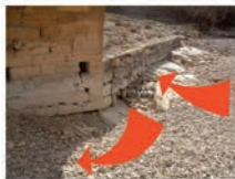
6.- Zona de Riesgo 1. Detalle del arranque del arco donde se aprecian los efectos de la erosión y el lavado de gravas por la formación de remolinos.
