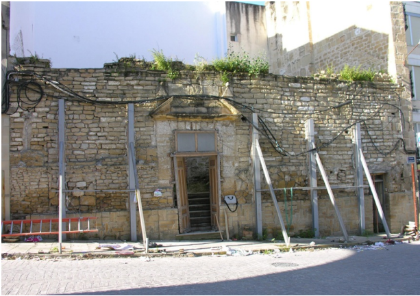
Fig 2. Edificio tras una intervención sin investigación previa. 2009. Fototeca ARQVIPO.
