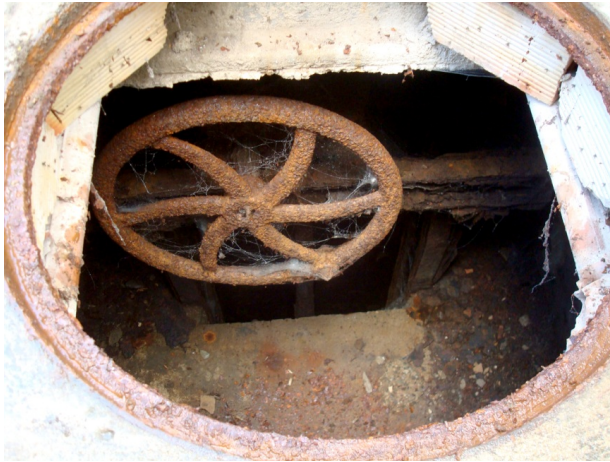
Fig 6. Compuerta de protección en acometida al Arroyo Tagarete. Ramal C. Estado actual. 2011. Fuente: elaboración propia.
