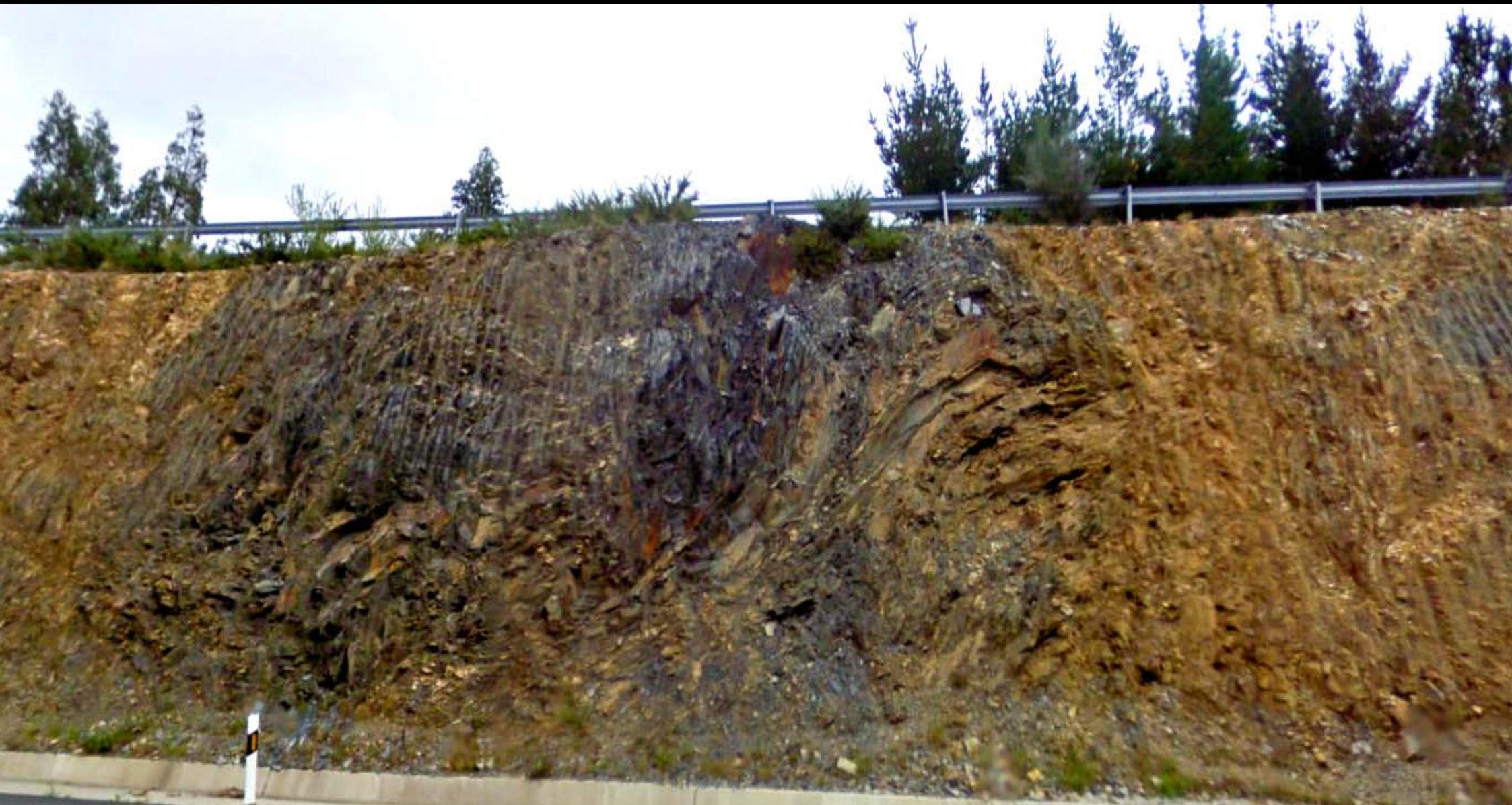
Detalle de los taludes anteriores en Filitas del Ordovícico Med y Sup. NNW de Porto dos Frades. E Hoja de Puente deume.
