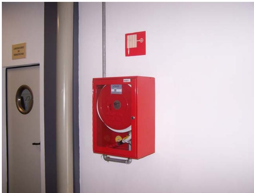
Figura 20: Boca de Incendio Equipada de 25 mm (BIE 25)
