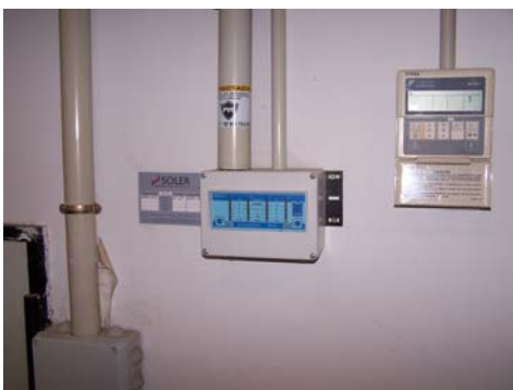
Central de detección de gas
