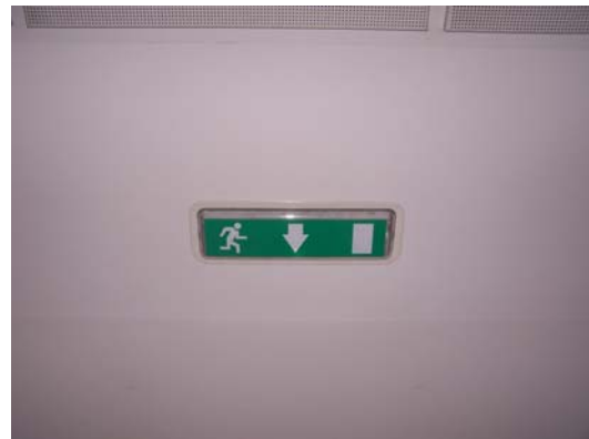
Luces de Salida de Emergencia
