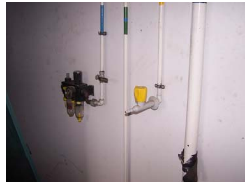
Toma de gas natural
