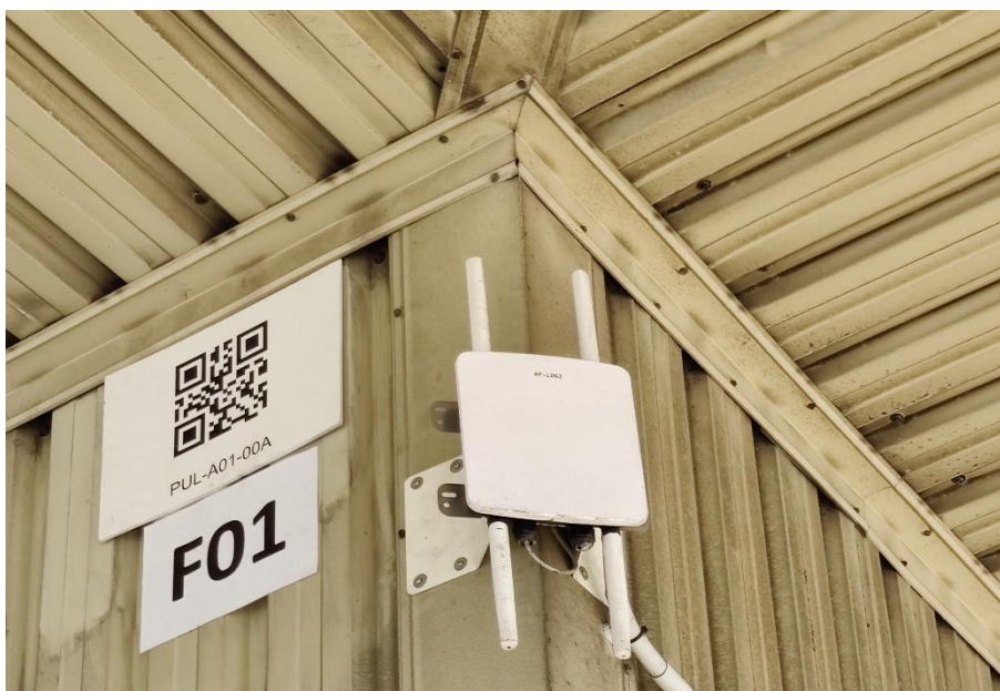
Ilustración 22: Repetidor Wi-Fi del almacén.
