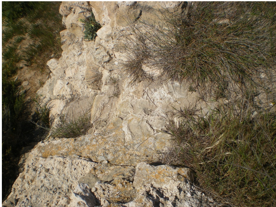
Fotos de abril de 2012, se observa restos del hueco del acceso a la torre.
