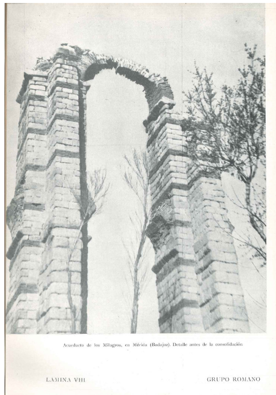
Figura 21. Grupo romano: Acueducto de los Milagros de Mérida Arq: F. Hernández Jiménez y J. Menéndez Pidal Lámina VIII de “Veinte Años de Restauración Monumental”
