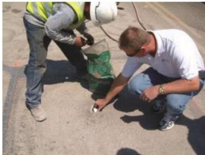
Fig. 21 Magnetómetro inalámbrico instalado (FHWA-HRT-08-001, 2007)
