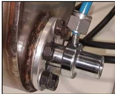
Figura 31. Tobera del compresor instalada
