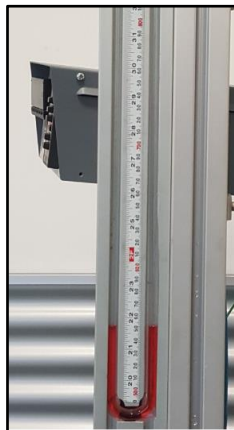
Figura 20. Columna de agua en U de la caldera
