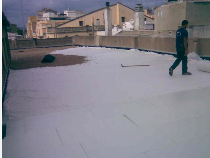
Foto 37 Colocación de paneles aislantes de poliestireno extruido, lámina de geotextil. Colocación inmediata de protección de grava para evitar que el viento se levante el aislamiento
