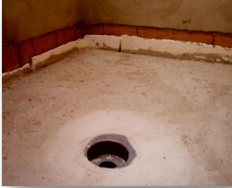
Foto 24 :Detalle de acabado de hormigón celular en sumidero. Se observa la banda perimetral ejecutada
