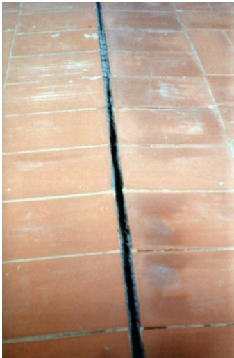
Foto 20 Junta en solado de cubierta sin material de sellado
