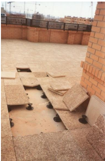
Foto 21 Rotura de pavimento flotante
