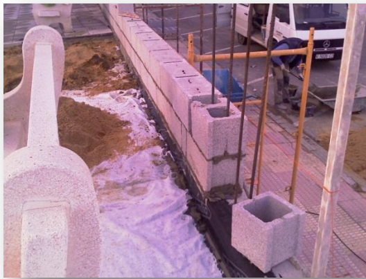
Foto 49 Realización de muro perimetral sobre el que se inserta la lámina impermeabilizante para evitar que el agua penetre por el encuentro con el muro
