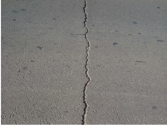
-Figura 53 –Grieta asfalto Avenida Naranjos
