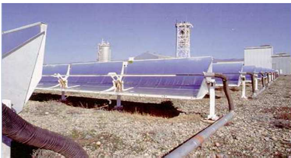
Figura 1: Campo de colectores distribuidos ACUREX
