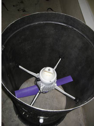
Figura 4: Anemómetro de conducto para medida del flujo de ventilación
