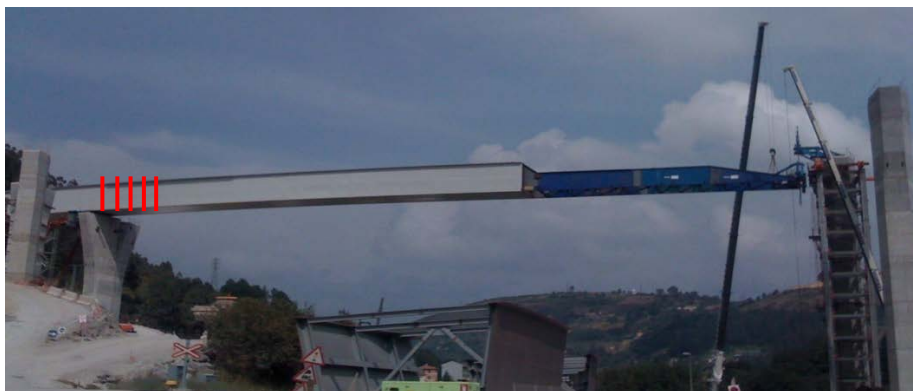
Figura 3.28. Situación final del lanzamiento monitorizado. La nariz del cajón apoya sobre la pila P1-3. En color rojo se muestran la posición de las 5 secciones instrumentadas.
