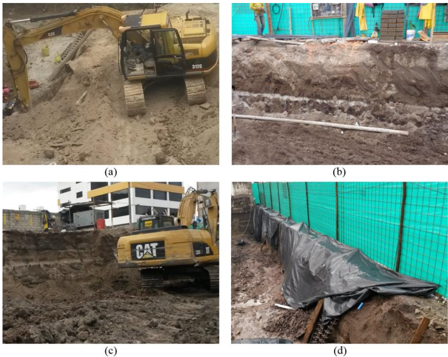
Fig. 4.18 Excavaciones para primer nivel de sótanos de edificios: (a) y (b) Torre Centre , y (c) y (d) Zaigen .
