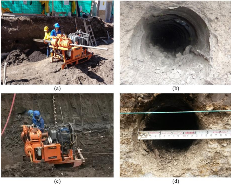
Fig. 4.19 Perforaciones para “Soil Nails” de muros de edificios: (a) y (b) Torre Centre, y (c) y (d) Zaigen.
