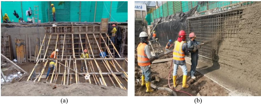
Fig. 4.22 (a) Hormigonado de muro de Torre Centre mediante sistema de encofrados, y (b) Hormigonado de muro de Zaigen mediante “ Shotcrete ”.
