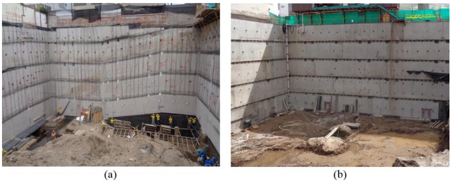
Fig. 4.24 (a) Muros anclados para sótanos de 5 niveles mediante la técnica de “Soil Nailing” para los edificios: (a) Torre Centre , y (b) Zaigen .
