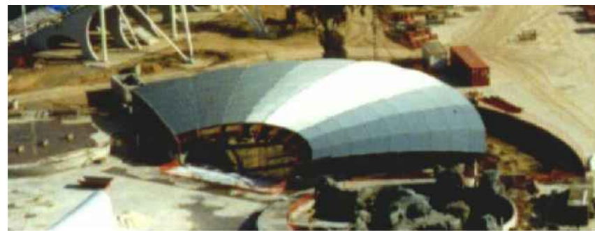
(Figura 6.6) Hueco abierto en la cubierta por el incidente
