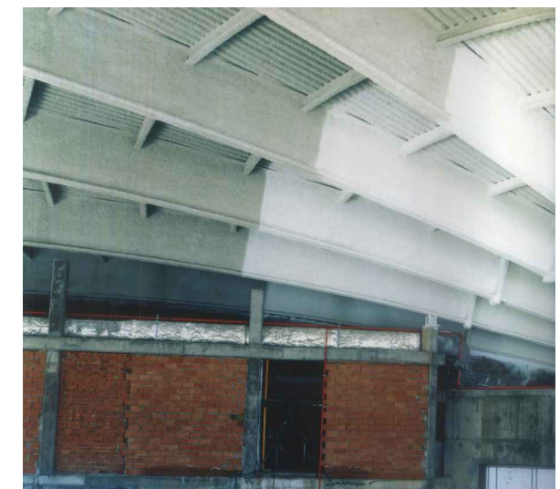
(Figura 5.4) Vista interior de las vigas con el tratamiento ignífugo ya proyectado
