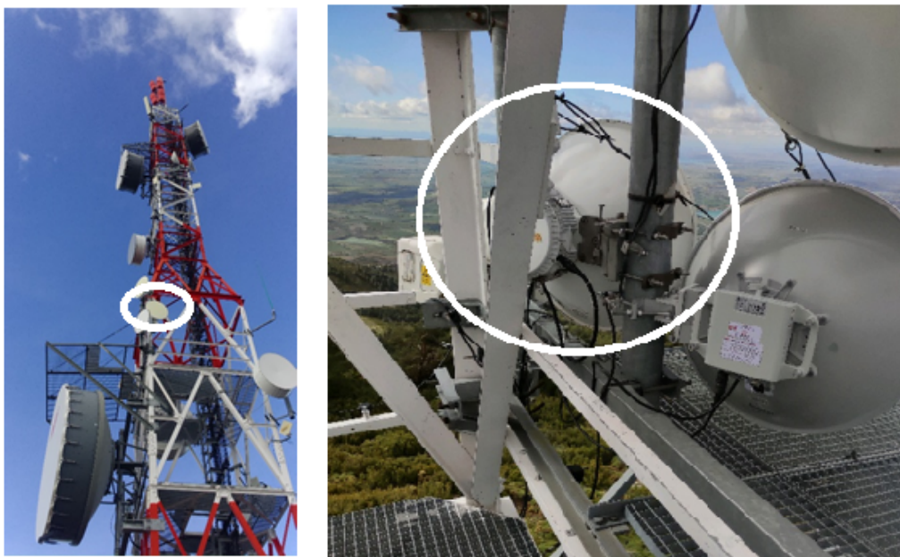
Figura C.1: Site origen. A la izquierda, parábola del radioenlace actual. A la derecha, parábola del radioenlace nuevo.
