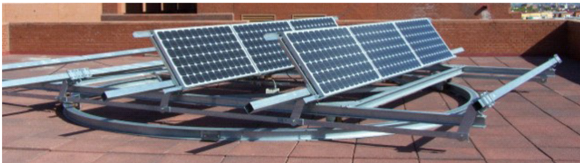
Fig. 6.1 Seguidor solar con una estructura tipo carrusel.
