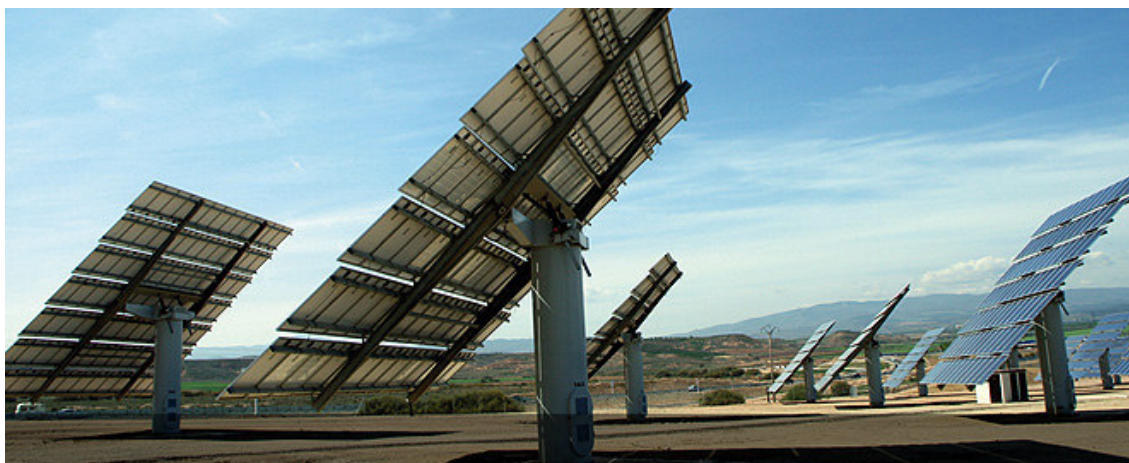
Fig. 1.3 Seguidor solar monoposte en 2 ejes, Ecoener.
