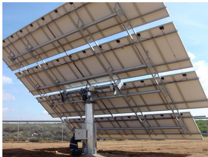
Fig. 6.2 Seguidor solar con una estructura tipo monoposte.
