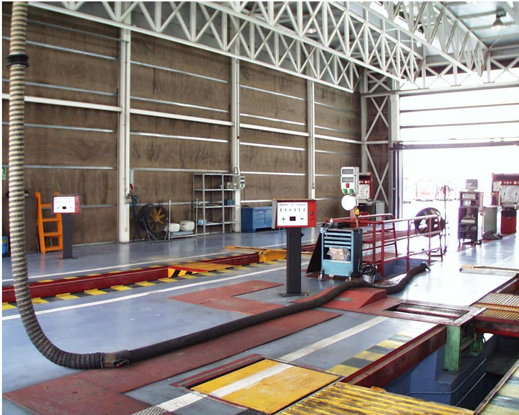
Figura 15. Vista de las líneas de pre-ITV del CDV.
