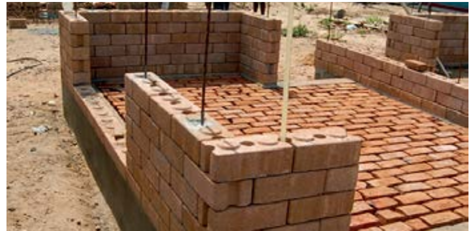
Construcción de una de las viviendas de Kirinda, Sri Lanka, con bloques de CEB https://arquitecturaviva.com/assets/uploads/obras/40810/av_74559.jpeg?h=dcf25785
