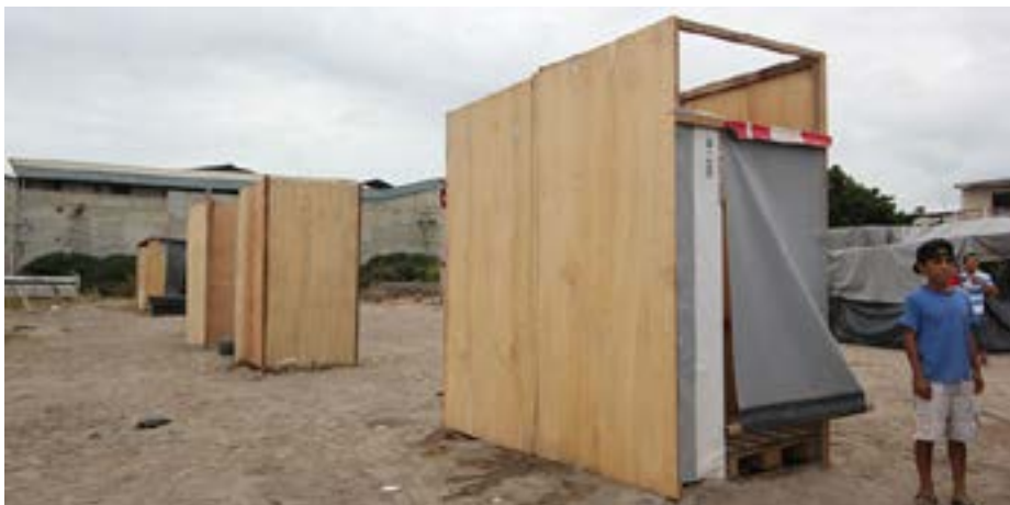
Red de Saneamiento. Retretes comunitarios apartados del refugio, Manta, Ecuador. http://www.shigerubanarchitects.com/works/2016_Ecuador2/08.JPG
