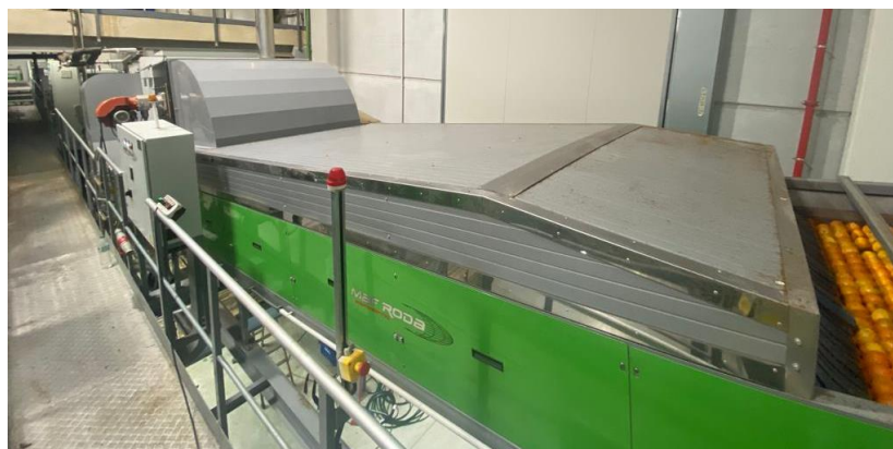
Ilustración 17. Túnel de secado.
