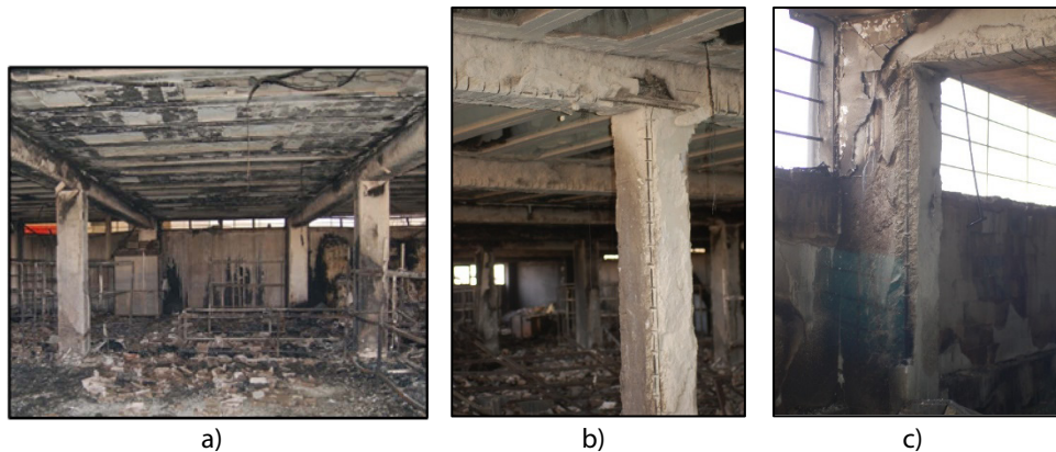
Figura 7.1 Construcción industrial de HA después de un incendio: a) vista general; b) columna central con spalling de esquina; c) columna lateral con spalling de esquina y de superficie
