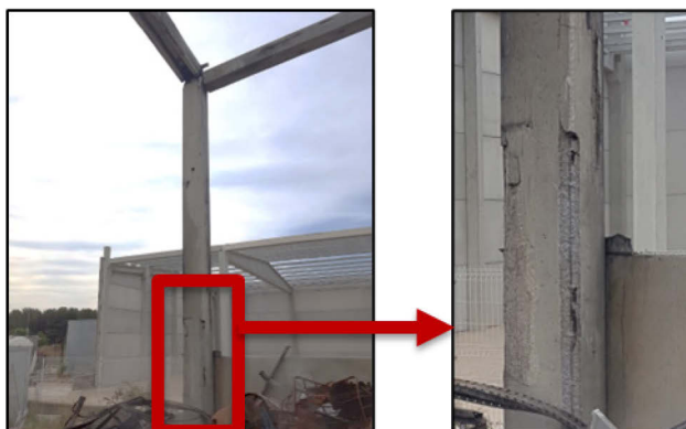
Figura 7.2 Columna esquinera de HA con spalling de esquina, después de un incendio
