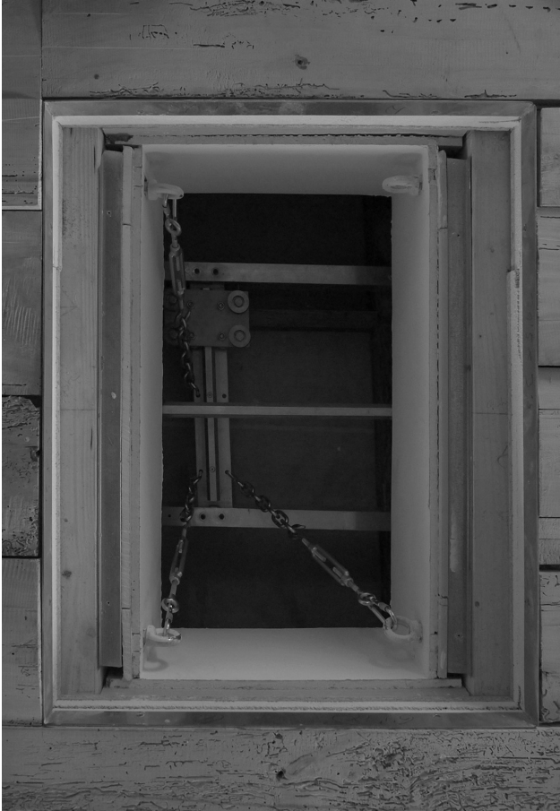
Figura 26. Sistema definitivo de sujeción de las obras visto a través de los registros instalados en la planta superior
