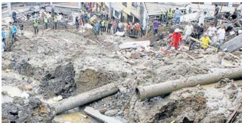
Figura 14. Fallo de conducción de hormigón relacionado con movimiento en masa
