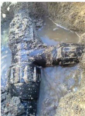
Figura 12. Fuga en empalme de tubería plástica
