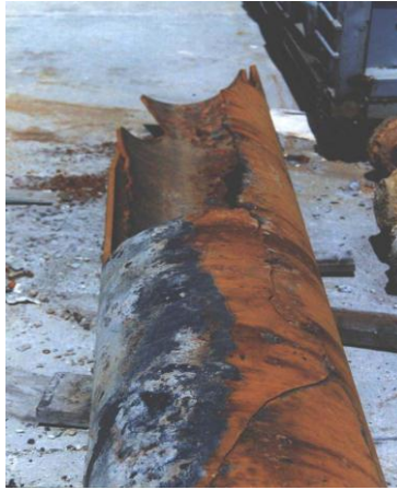
Figura 5. Fallo por corrosión en tubería de fundición dúctil
