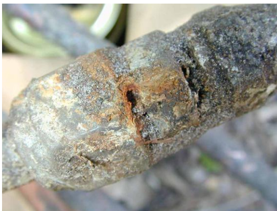
Figura 7. Fallo en la unión entre tubería y codo debido a un deficiente galvanizado
