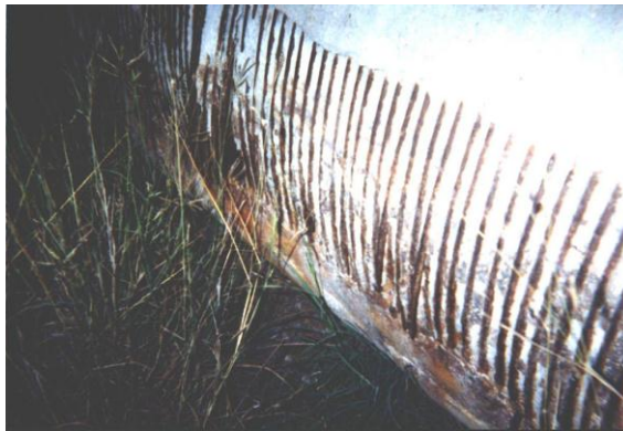
Figura 9. Fallo por exposición del refuerzo metálico
