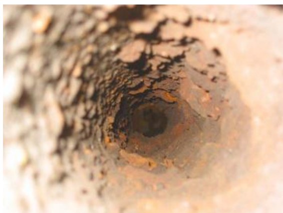
Figura 4. Reducción del diámetro en una tubería de fundición gris de diámetro 4 pulgadas
