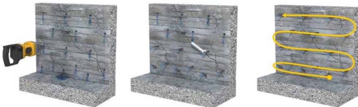
Figura 37: Realización de taladros Figura 38: Colocación de inyectores Figura 39: Inyección de la resina
