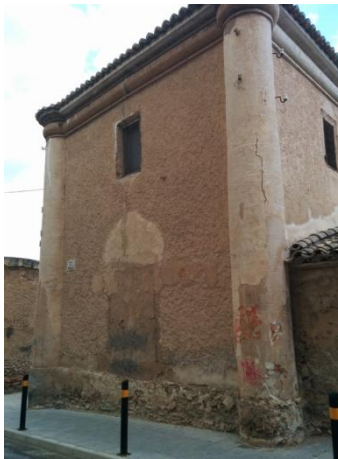
Imagen 36. Grieta en contrafuerte, fachada oeste. 2014. Fuente: J.C.A.
