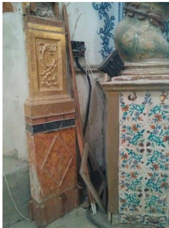
Imagen 40. Elementos impropios camarín.2014. Fuente: J.C.A.
