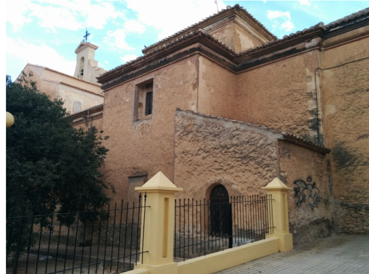
Zona afectada fachada norte
