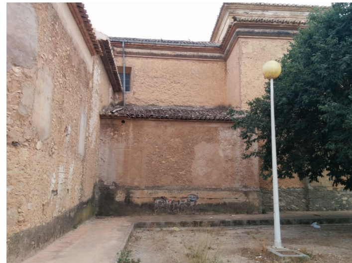
Zona afectada fachada norte
