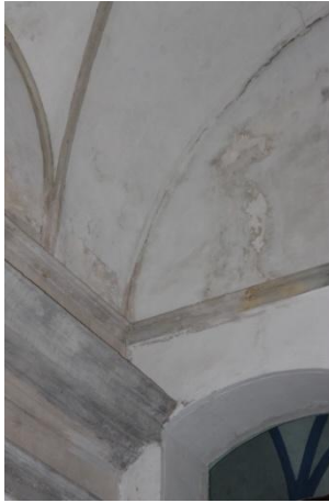
Imagen 39. Manchas humedad nave central. 2014. Fuente: J.C.A.
