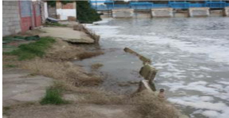
Imagen 2 Muro de hormigón desplazado
