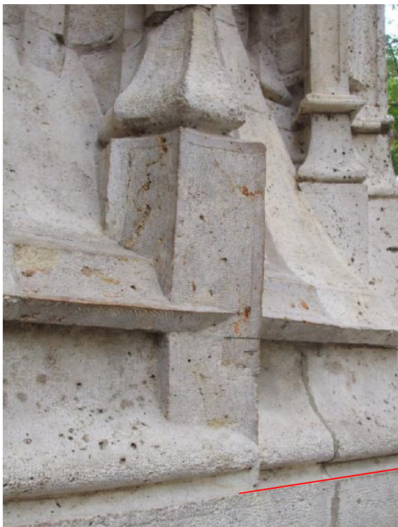
Imagen 201 DETALLE de la jamba de estudio en donde destaca la alineación horizontal cota cero resaltada con una línea de color rojo. Esta línea no se aprecia horizontal por la inclinación en la toma de la fotografía. Fuente propia.
