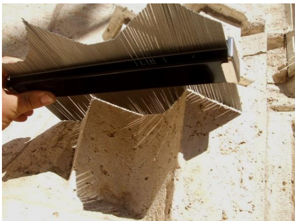
Imagen 220 PEINE ARQUEÓLOGO. Vista del levantamiento del arranque de las cañas que vemos en la imagen de la derecha. Fuente propia.
