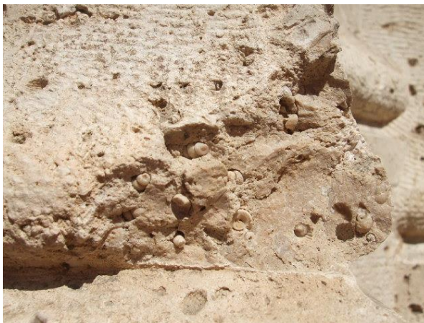
Imagen 138 MANIFESTACIONES PATOLÓGICAS de la piedra. Pátina de suciedad en las piedras inferiores. Fuente propia 2015.
