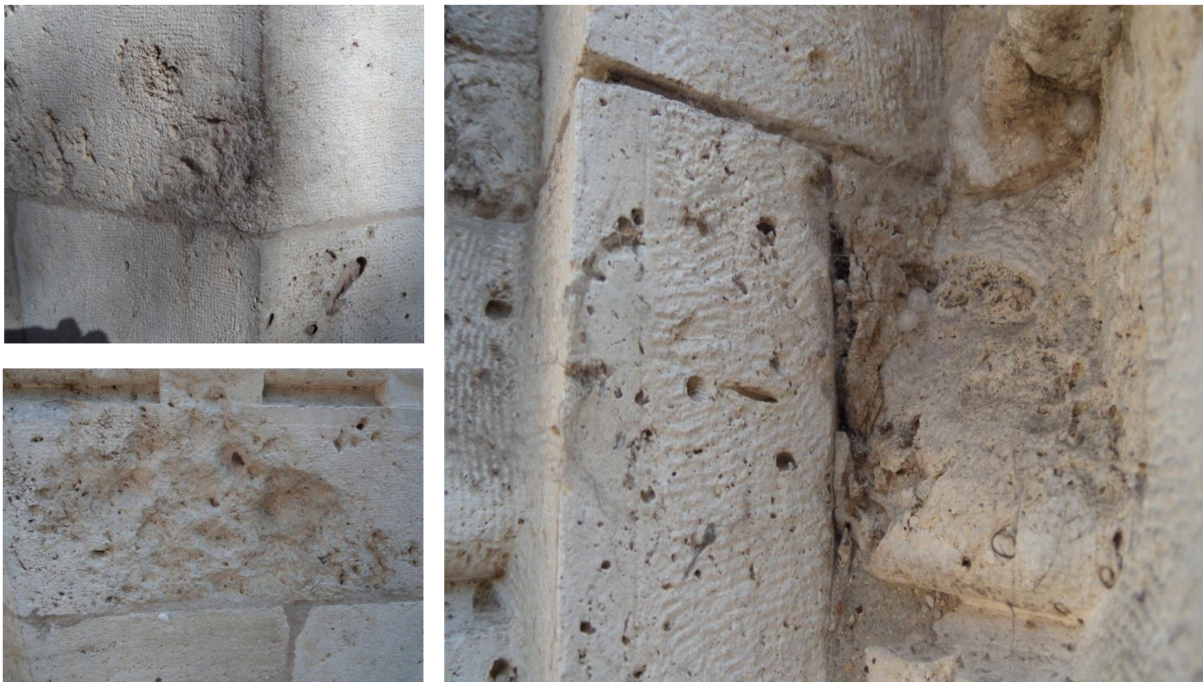
Imágenes 265 ACANALADURAS VERMICULADURAS Y NUEVAS EXFOLIACIONES por desplazación en las piedras de las jambas de la Lonja de Valencia. Fuentes propias.
