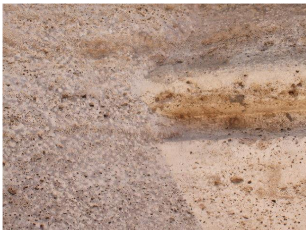
Imagen 136 POROSIDAD. Vista en detalle de la piedra de la jamba de la portada principal de la Lonja de Valencia. Fuente propia.
