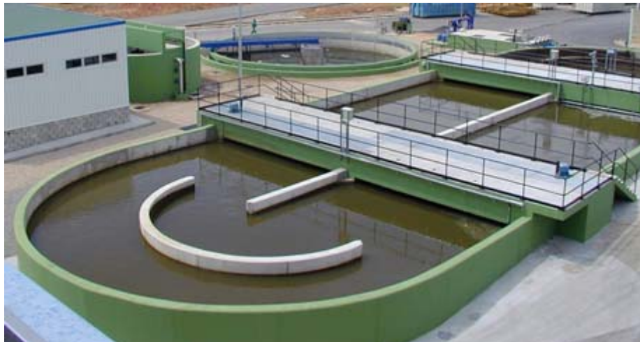
Figura 3.2. Tratamiento biológico de la depuradora de aguas residuales industriales de Ford.
