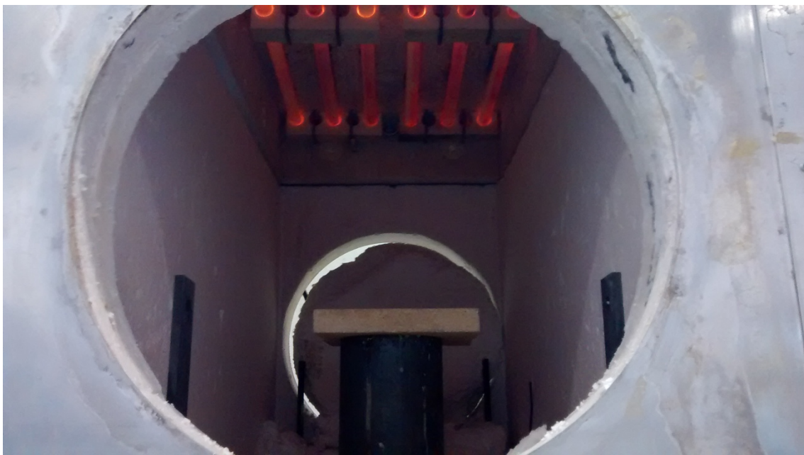
Imagen 37.- Horno funcionando con la puerta abierta.
