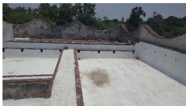
Figura 12 – Detalle de la presencia de estancamientos de agua en el techo tras muchos días sin precipitaciones.
