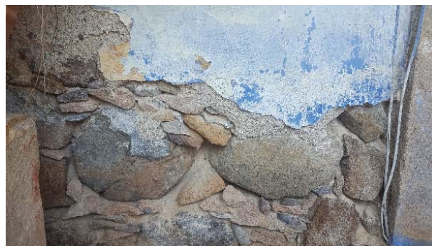
Figura 17 – Detalle de los fenómenos de disgregación, pulverización y pérdida de los aplanados en la parte perimetral inferior de las decoraciones (mayo 2017).
