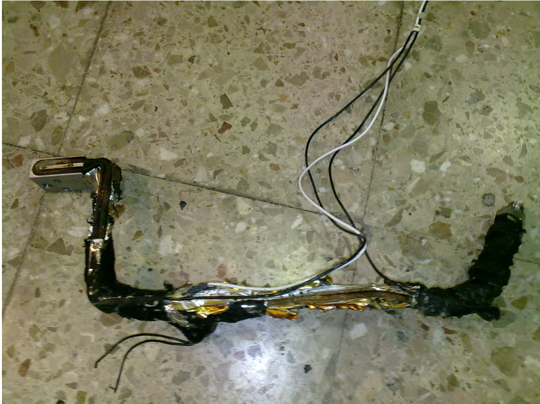
Figura 172. Resistencia y conducto de dispensadora de parafina
