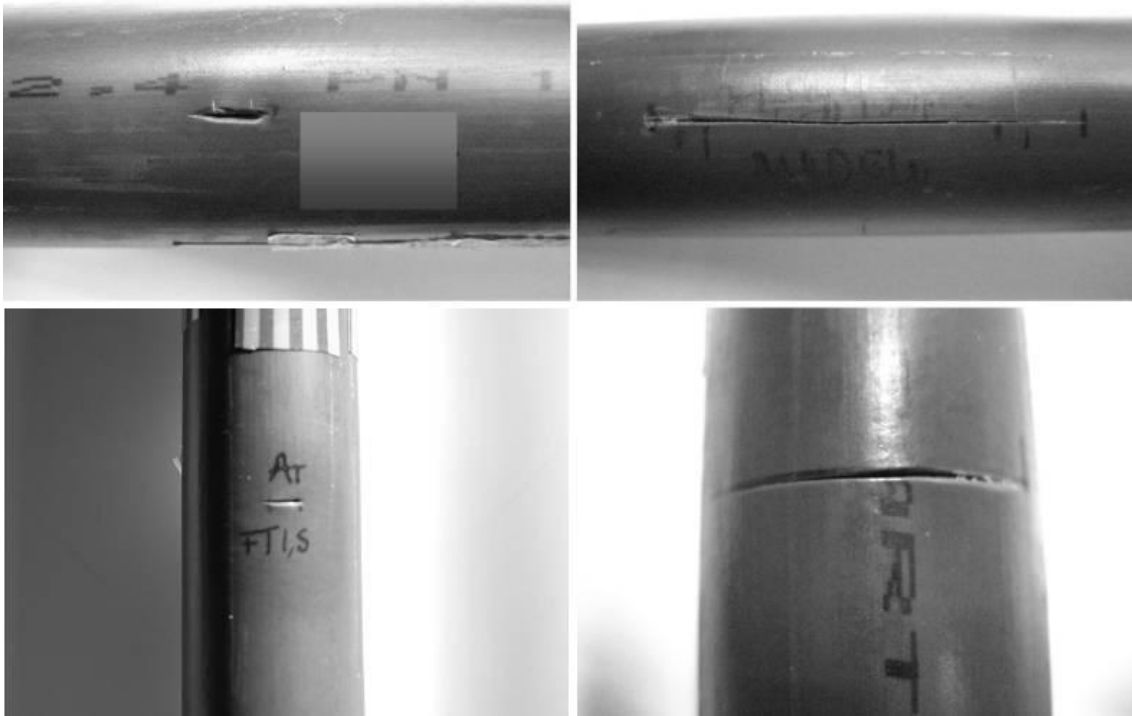
Figura 3.15 Fallos longitudinales y transversales
