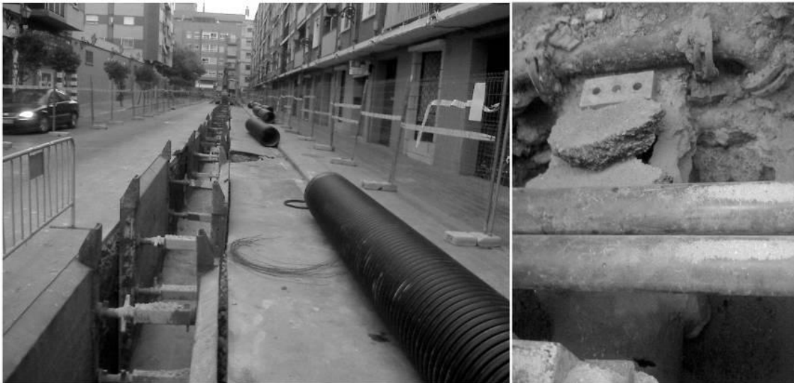
Figura 2.3 Colector principal (Izquierda) y sifón en conducción de agua (derecha)
