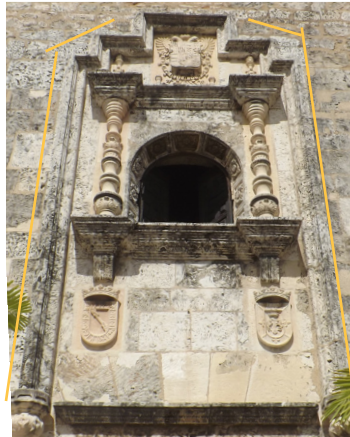
Detalle del arrabá en piedra que fue reconstruido en el siglo XX a partir de huellas.
