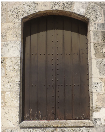
Detalle de puerta de dos hojas en madera reconstruida en el siglo XX
