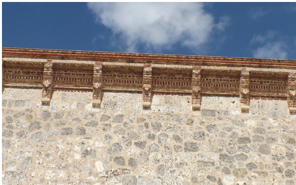
Vista de la cornisa y aleros en ladrillos añadidos a la edificación en el siglo XX.
