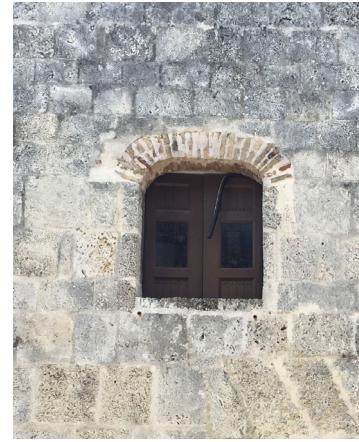
Detalle de ventana adovelada de dos hojas de madera reconstruida en el siglo XX.
