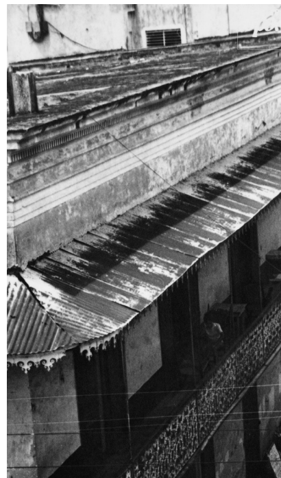
Vista de los elementos impropios antes de ser removidos. Fuente: Centro de Inventario de Bienes Culturales de Santo Domingo (CIBC)
