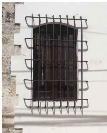
Detalle de ventana con arco rebajado y dos hojas de madera con cristal.
