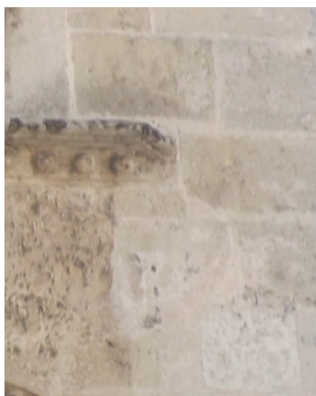
Detalle de piedra tallada en una de las paredes de la edificación.
