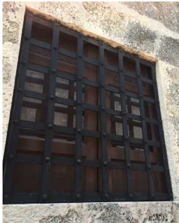
Detalle de ventana de dos hojas de madera y con rejería, reconstruida en el siglo XX.
