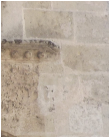
Detalle de piedra tallada en una de las paredes de la edificación.
