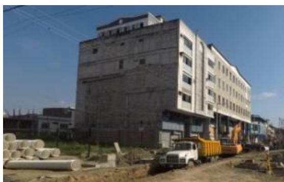
Ilustración 27: Solar donde estuvo ubicada la Casa Barcia derrocada posterior al terremoto del 16A, 2018. (Manuel Barcia, 2018)
