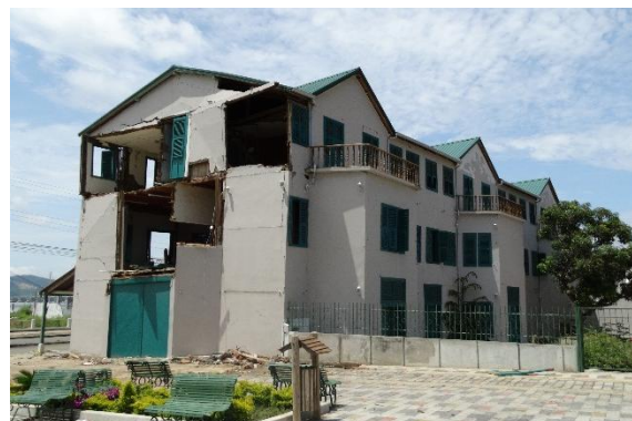
Ilustración 109: Casa Americana post terremoto del 16A. (Manuel Barcia, abril de 2016)
