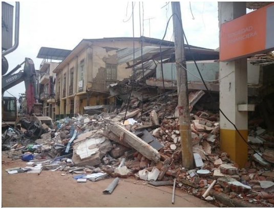
Ilustración 113: Edificaciones colapsadas sobre la calle Olmedo en Portoviejo. (Manuel Barcia, 2016)
