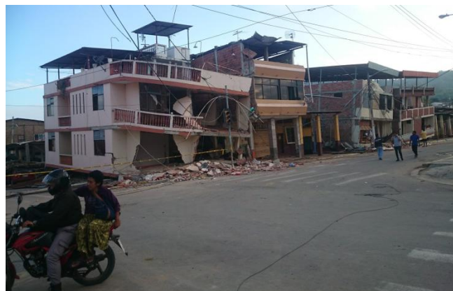
Ilustración 112: Varias edificaciones de hormigón armado colapsadas tras el 16A en la calle 10 de agosto. (Manuel Barcia, abril 2016)
