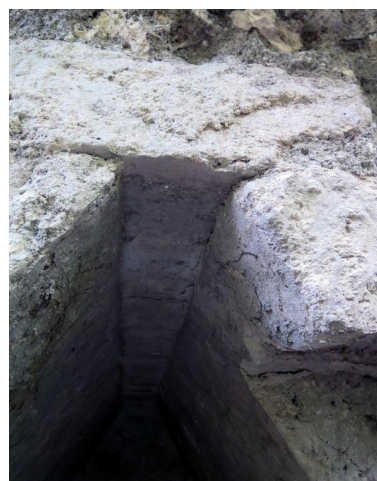
Figura 215. Detalle del remate de la bóveda del cuarto 3 del Edificio 6J2-Sub2 de La Blanca, donde se aprecia la tapa previamente estucada.
