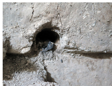
Figura 228. Restos de la madera de un morillo en una bóveda del Edificio 6J2-Sub2 de La Blanca.
