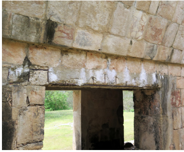
Figura 377. Dintel de hormigón armado con graves problemas de conservación en la Casa de las Tortugas de Uxmal.
