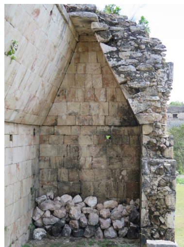
Figura 192. Bóveda del cuarto oeste de la Casa de las Tortugas de Uxmal.
