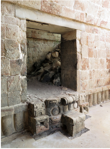
Figura 382. Cargadero de hormigón armado con problemas de conservación en el Edificio Codz Pop de Kabah.
