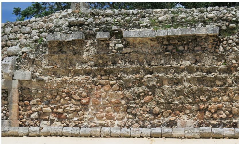
Figura 249. Muro del Juego de Pelota de Uxmal, en el que se aprecia la huella de los sillares desprendidos.
