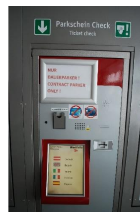
Ilustración 53: Máquina de ticket del garaje mecanizado
