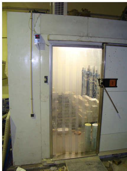
Figura 4.13. Cámara con humedad y temperatura controladas.
