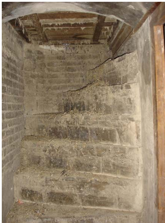
Acceso impedido por la torre izquierda
