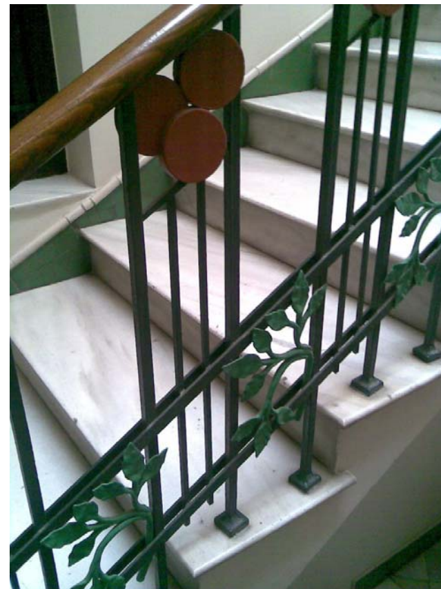
Escalera de la casa de Vicente Ferrer de Valencia. Ejemplo del Modernismo puro
