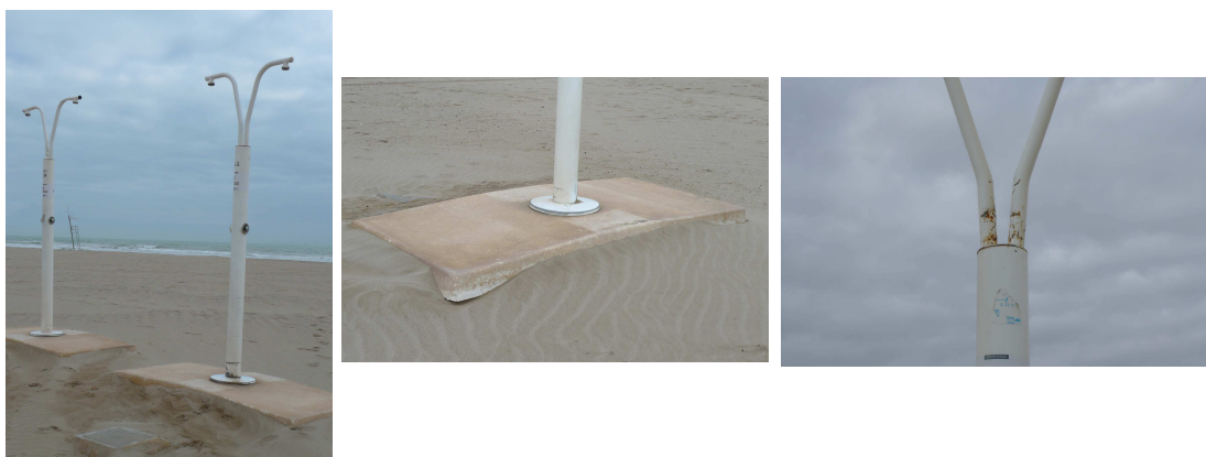
Imagen 4. De izquierda a derecha, detalles que permiten observar la arqueta de registro que ha quedado al descubierto, la plataforma de la ducha con la solera de fijación y la corrosión derivada de la exposición al ambiente marino.
