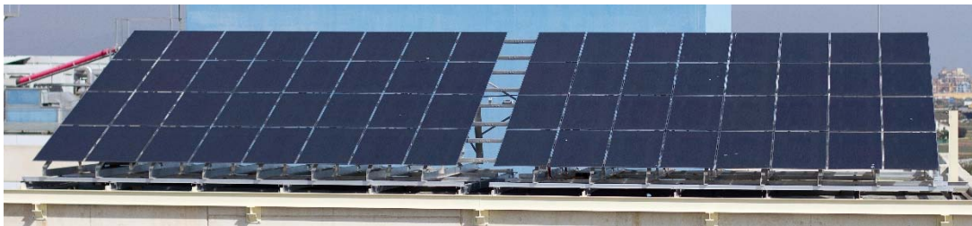
Fig. 2. ETSID photovoltaic field.
