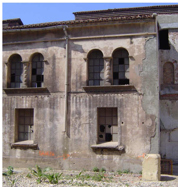
Figura 2.16 – Vista de la fachada Este donde se observa el sistema de recogida de pluviales.
