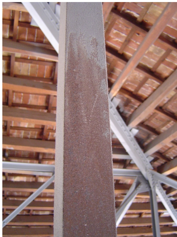
Figura 5.6 – Defecto de imprimación en la cercha metálica.
