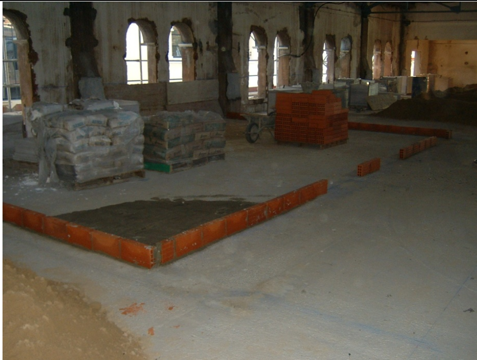
51.- Replanteo de los núcleos de aseos empleando una hilada de ladrillo hueco.
