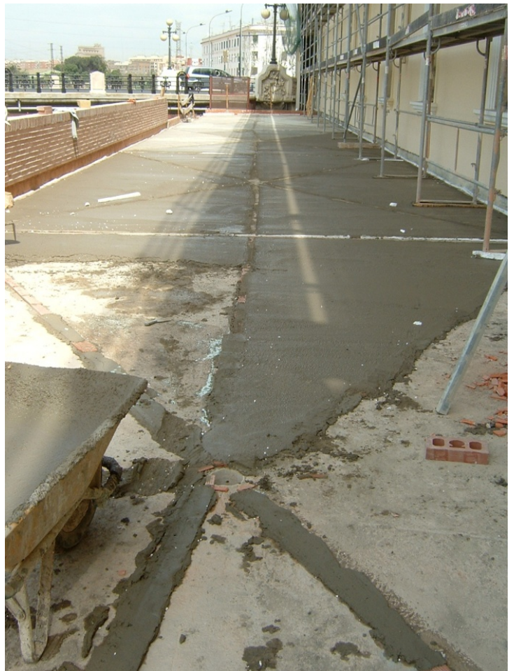
146.- Formación de pendientes de la plataforma de acceso al edificio mediante mortero de cemento.
