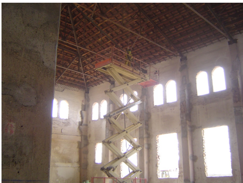
2.- Picado de los huecos de fachada adaptándolos a las medidas del proyecto.
