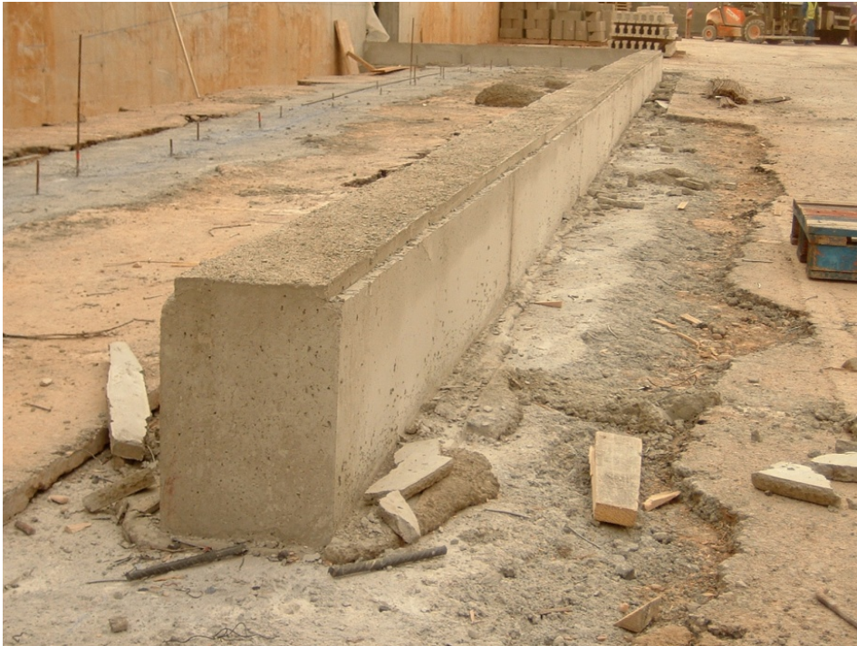
57.- Zócalo de hormigón armado para la fábrica de ladrillo caravista de las rampas y escaleras de acceso al edificio.
