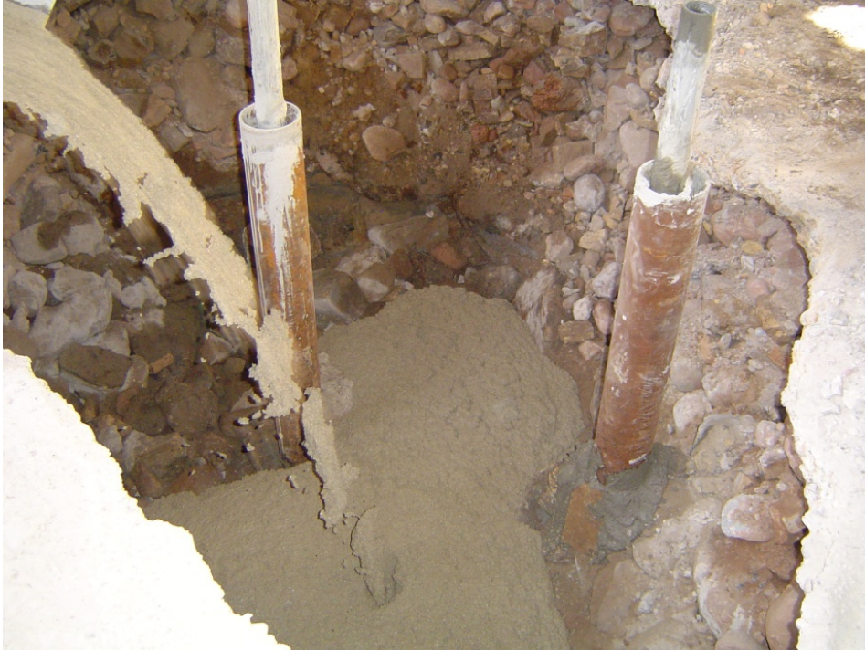
8.- Relleno con hormigón de la excavación realizada para la extracción de los restos de fundición.
