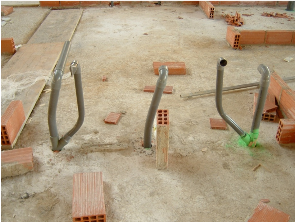
93.- Conexiones para los aparatos sanitarios de la instalación de saneamiento.
