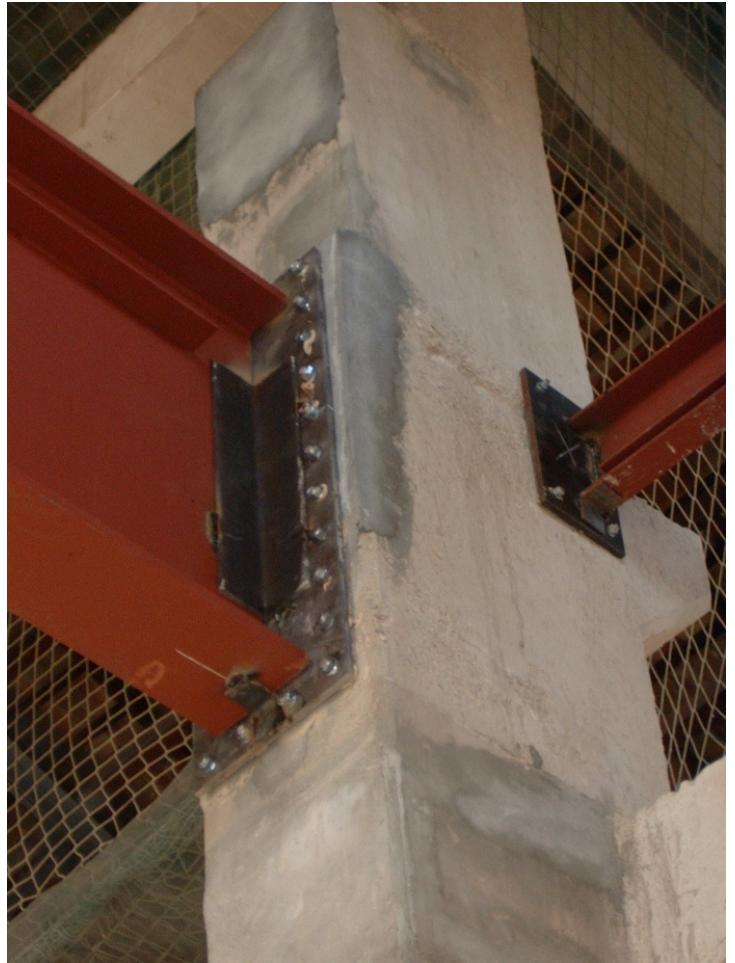
29.- Detalle de la unión de una viga alveolada sobre la placa de anclaje.
