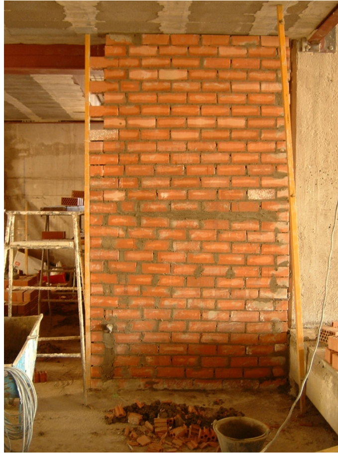
Figura 5.20 – Fábrica de ladrillo perforado deficientemente ejecutada.
