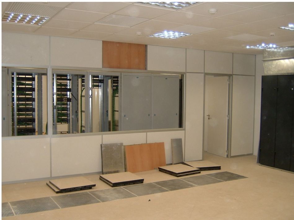
181.- Ejecución de las mamparas entre las distintas estancias del Centro de Proceso de Datos.
