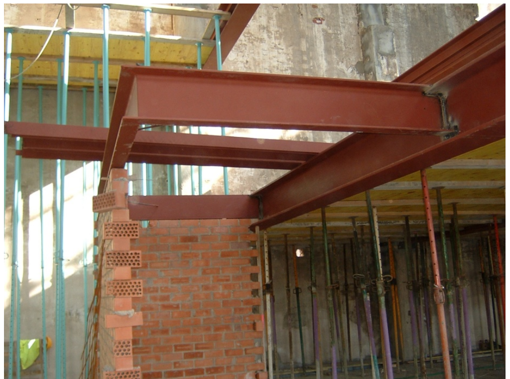
40.- Huevo para la caja del ascensor realizada con ladrillo perforado y perfiles metálicos UPN.
