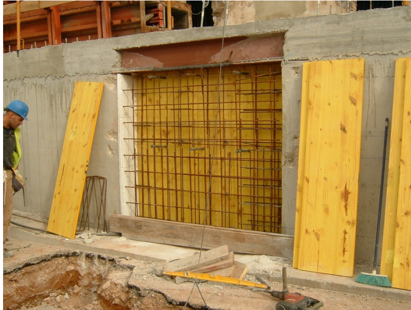
Figura 5.12 – Cegado del hueco del muro por error del replanteo.
