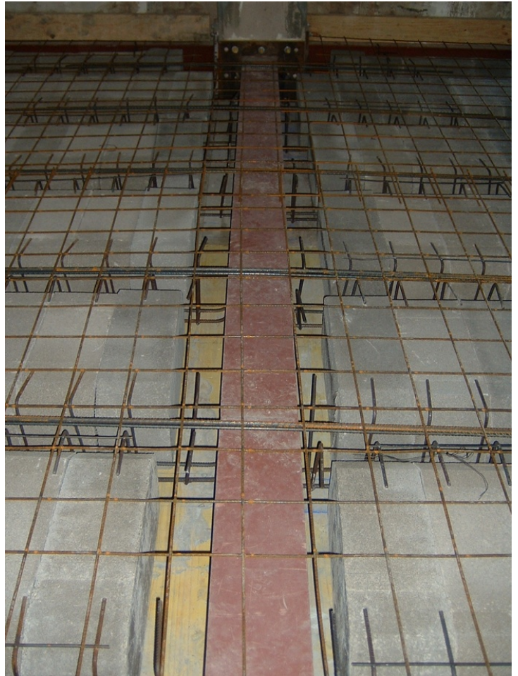
45.- Armado del forjado de planta primera realizado mediante nervios hormigonados "in situ".
