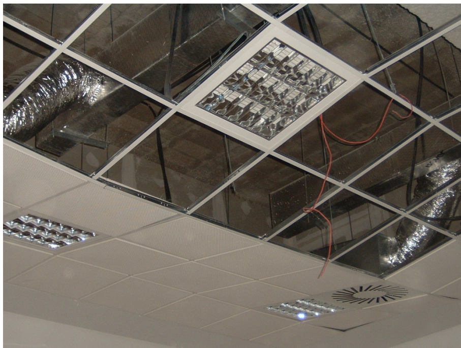
Figura 5.34 – Colapso del falso techo de la antesala al salón de actos.
