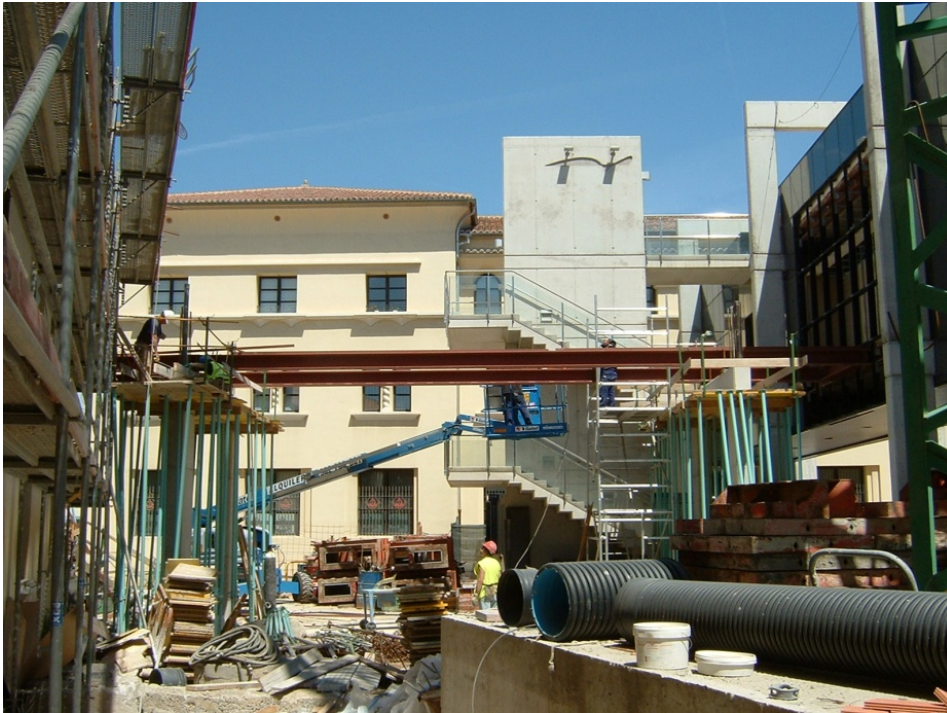
145.- Colocación de vigas metálicas para la ejecución del forjado de la pasarela de conexión entre edificios.
