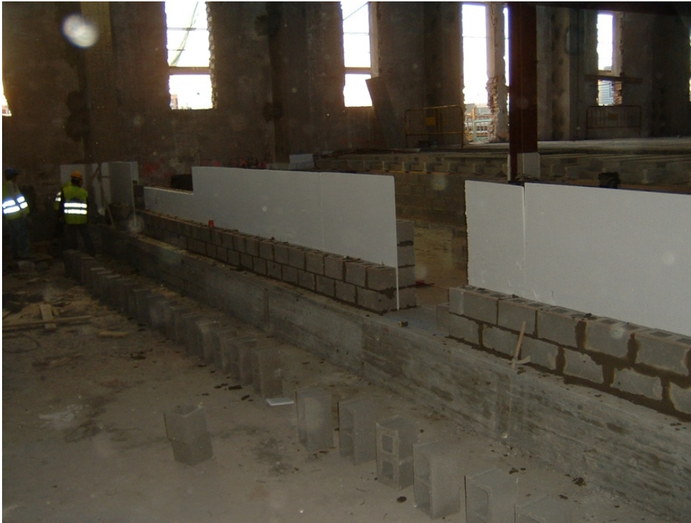
39.- Junta estructural en el apoyo del forjado sanitario mediante la duplicación de los muros de apoyo.
