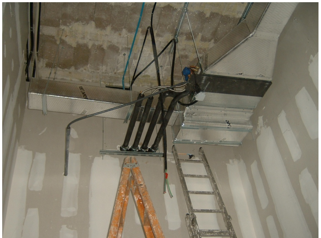
142.- Conexión de las unidades climatizadoras a las tuberías de impulsión y retorno de fluido caloportador, y a la tubería de desagüe.
