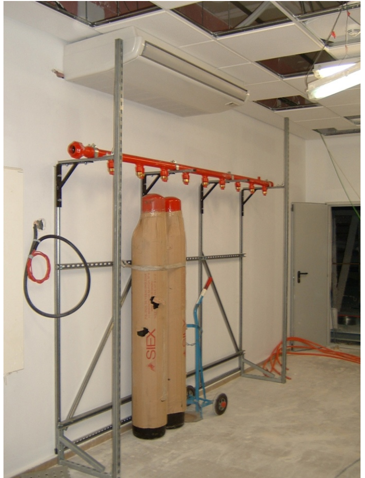
178.- Depósitos de argón para la instalación de extinción de incendios del Centro de Proceso de Datos.
