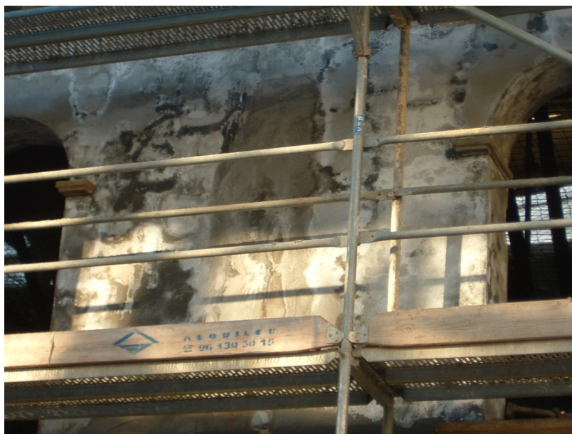
Figura 5.8 – Manchas de humedad en la fachada tras el enfoscado.
