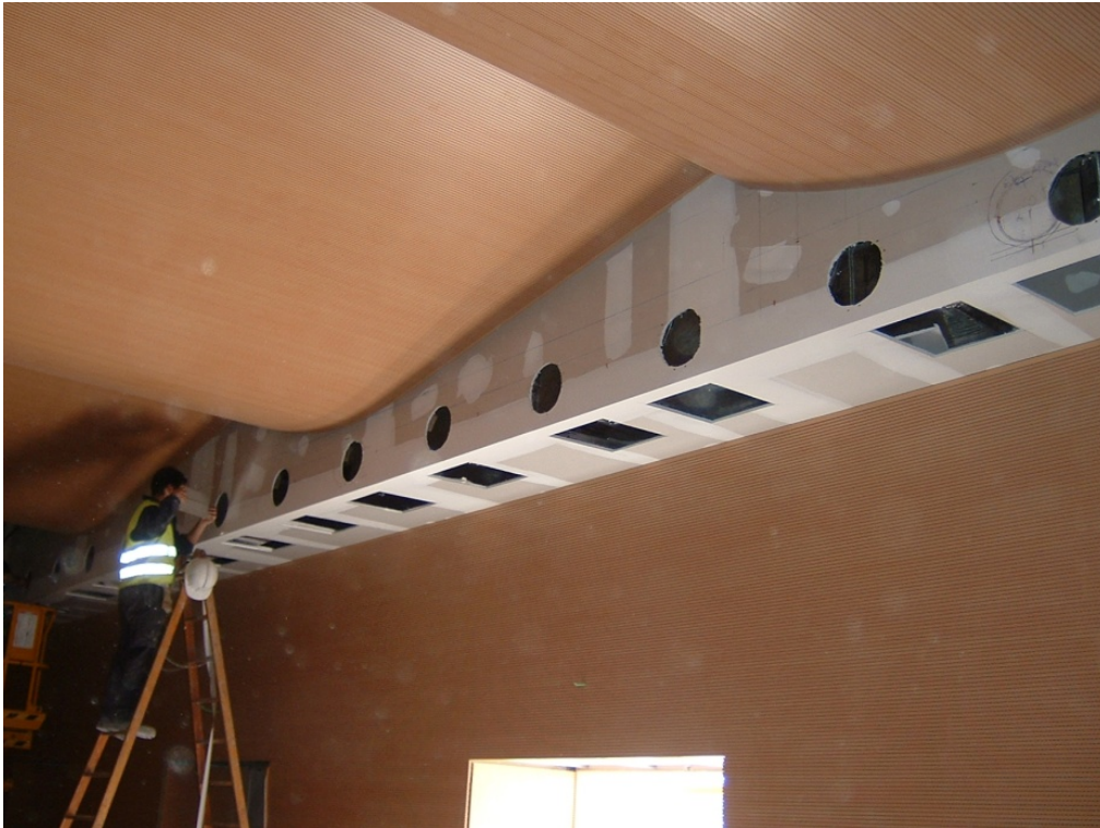
135.- Impulsión del aire climatizado del salón de actos mediante un sistema lineal de toberas direccionales.
