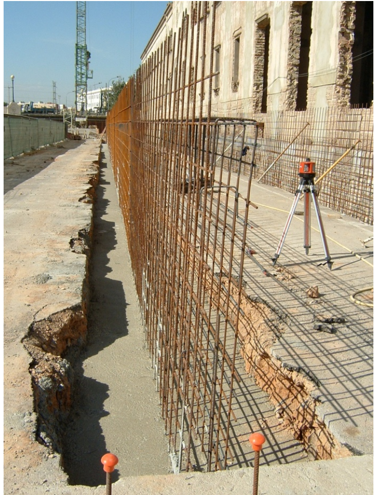
13.- Armado de los muros de apoyo para la plataforma exterior de entrada.
