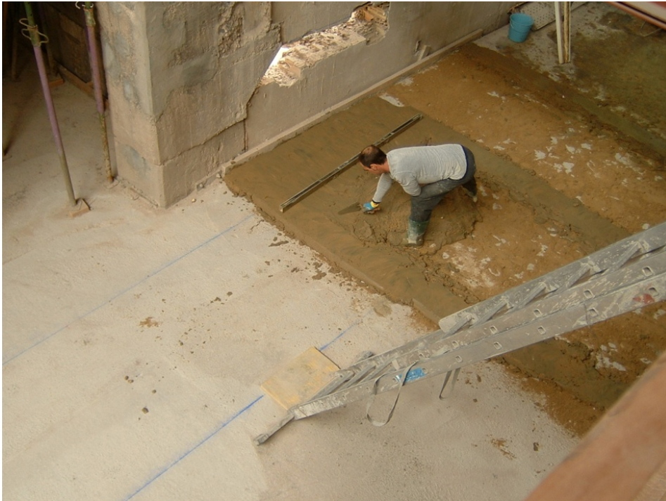
55.- Extendido de la capa de mortero bastardo para la colocación de las baldosas de mármol.
