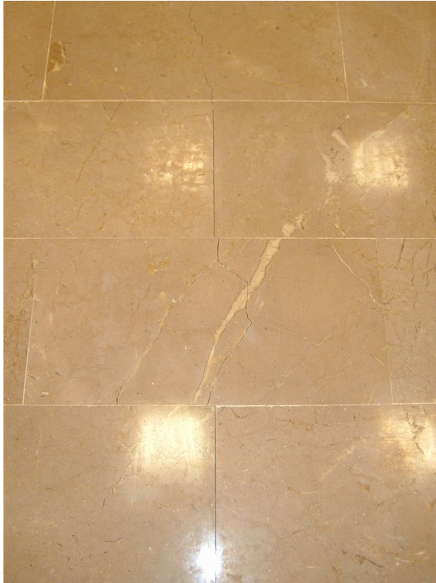
Figura 5.23 – Grieta en el solado de la antesala al salón de actos
