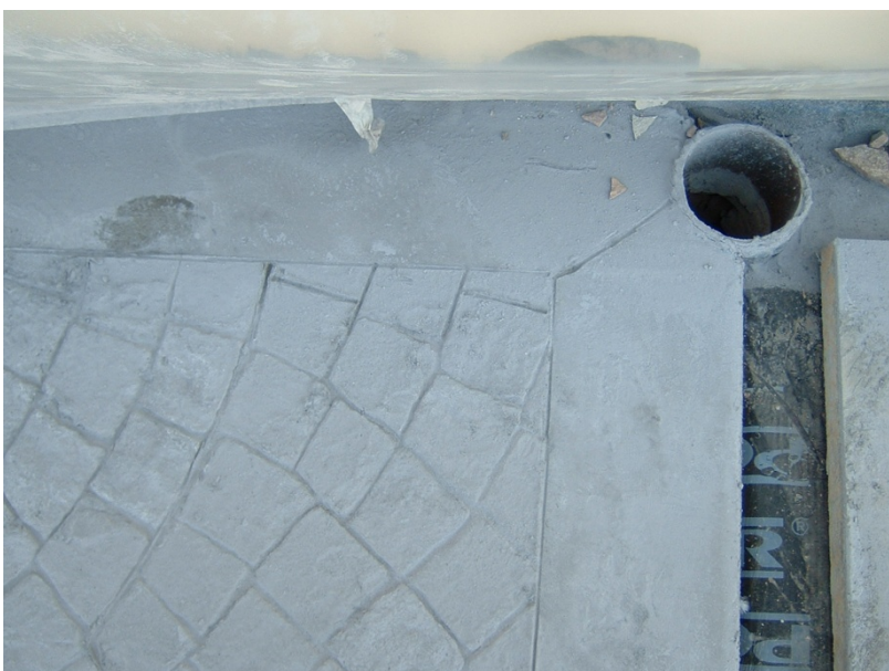
159.- Ejecución del pavimento de hormigón impreso en la plataforma de acceso al edificio.
