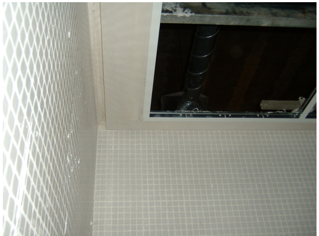
136.- Detalle del encuentro de la bandeja perimetral de escayola del falso techo con la tabiquería mediante el empleo de oscuro.
