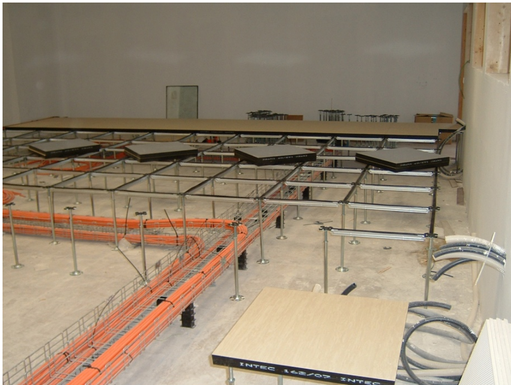
177.- Distribución del suelo técnico en el Centro de Proceso de Datos.
