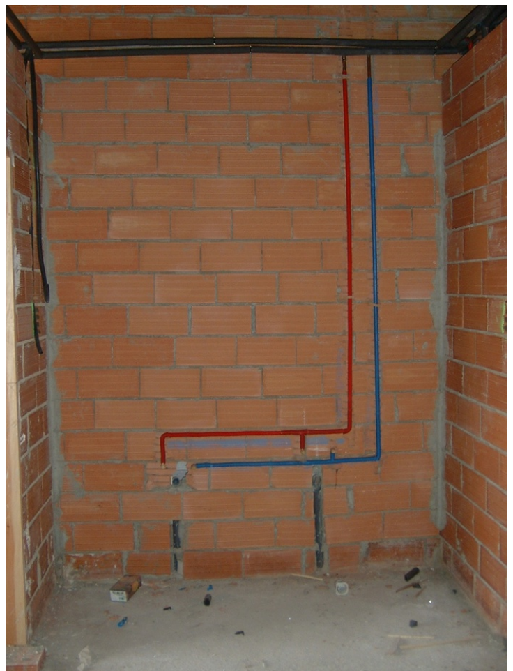
124.- Derivaciones individuales de agua caliente sanitaria y agua fría para los lavabos.
