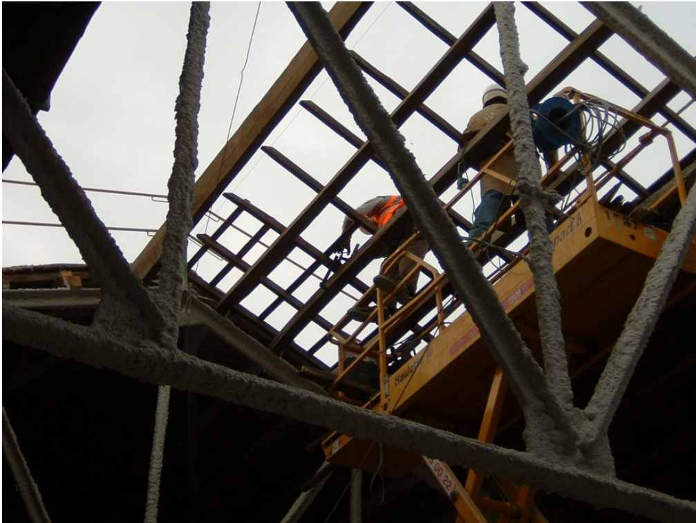
75.- Restitución de correas, cabios y latas de madera en los huecos del tejado.
