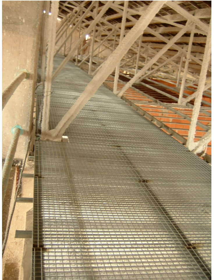
95.- Suelo de rejilla metálica instalado sobre las cerchas para el registro y mantenimiento de las instalaciones.
