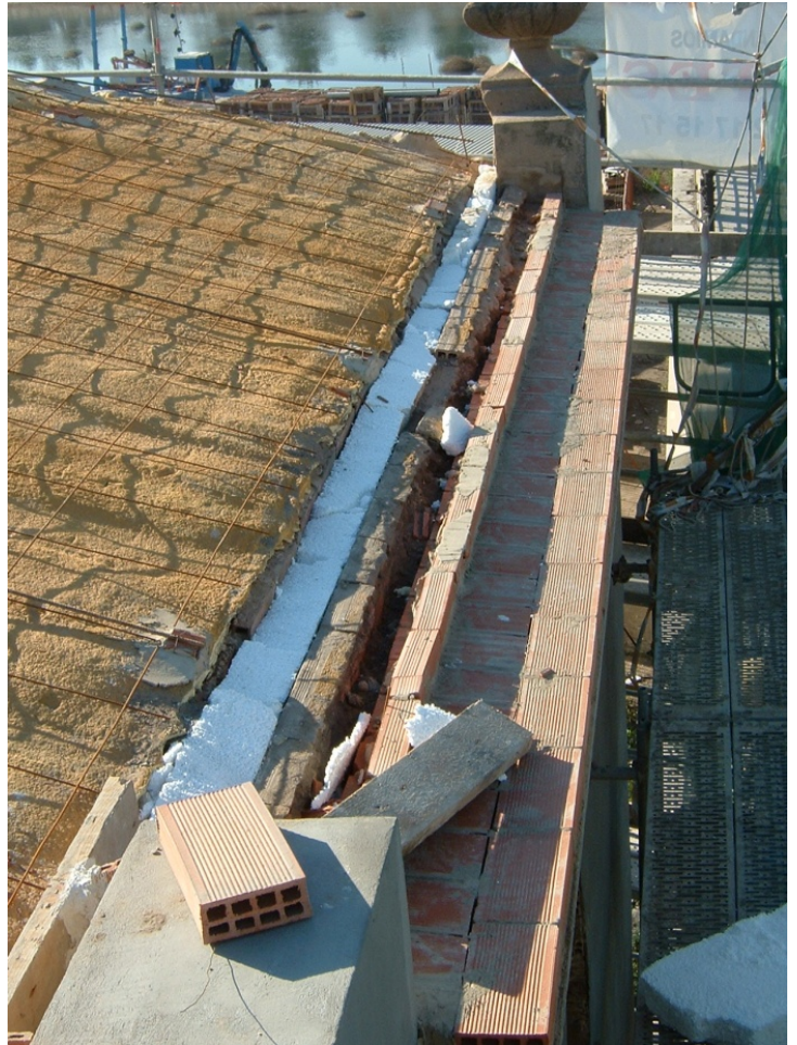
35.- Junta entre el tablero de cubierta y la cornisa de coronación de la fachada.
