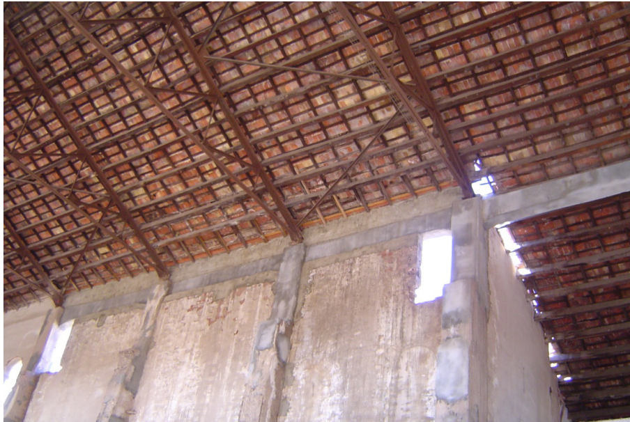
Figura 2.13 – Vista interior de la zona del tejado afectada.
