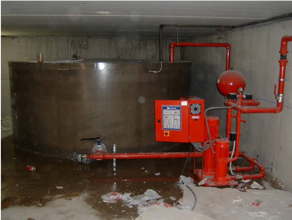
154.- Depósito y grupo de presión de la instalación de bocas de incendio equipadas.
