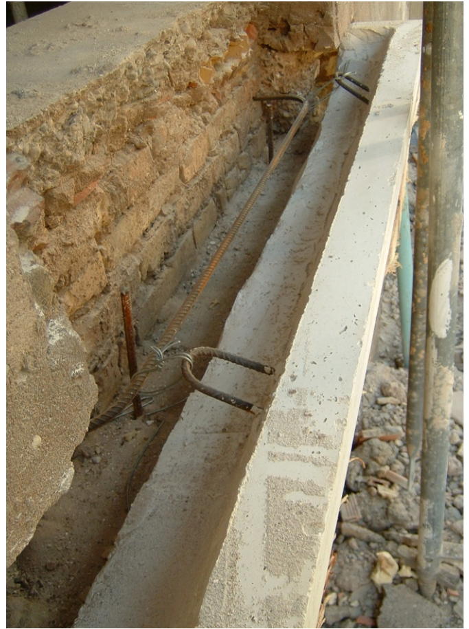
53.- Detalle del anclaje de los verteaguas a la fábrica de ladrillo de la fachada existente.
