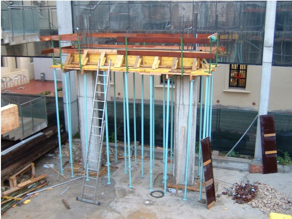
61.- Encofrado de las vigas de hormigón armado visto de la estructura de la pasarela.
