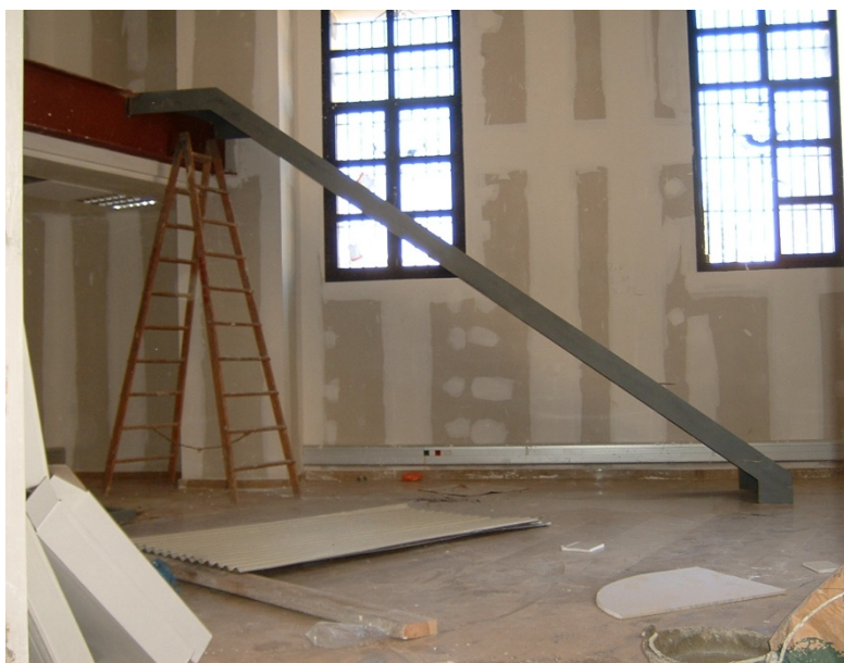
173.- Colocación de escaleras metálicas para el acceso a los altillos de la planta baja.
