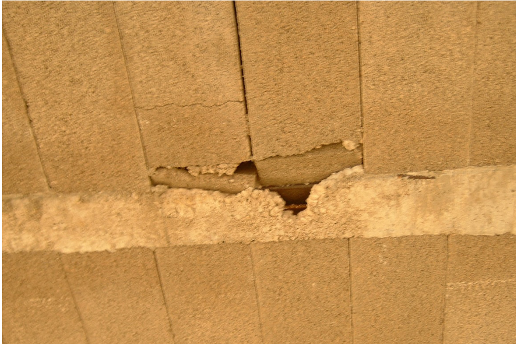
Figura 5.19 – Defecto de hormigonado en los nervios del forjado de planta 1ª
