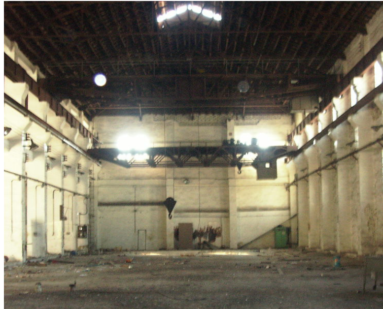
Figura 2.15 – Vista interior de la nave dónde se observa la instalación de puente grúa.
