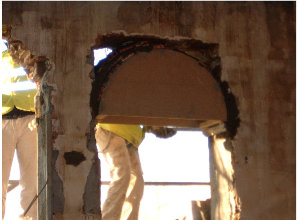
47.- Ejecución de arcos de medio punto en los huecos de fachada mediante el empleo de cimbras de madera.
