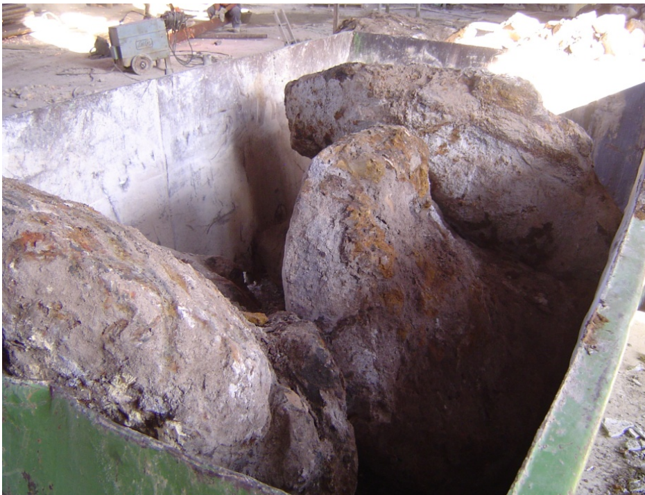
7.- Restos metálicos de fundición encontrados bajo la solera al ejecutar el micropilotaje.
