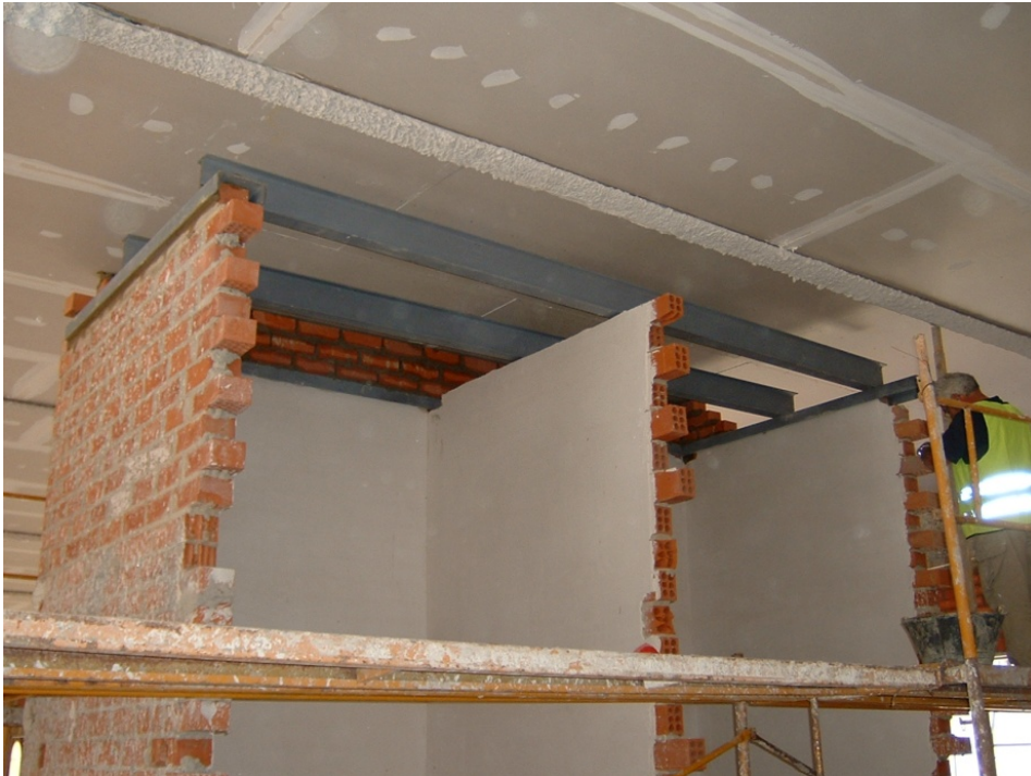
123.- Colocación de perfiles metálicos IPE sobre durmientes UPN para la instalación de los ascensores.
