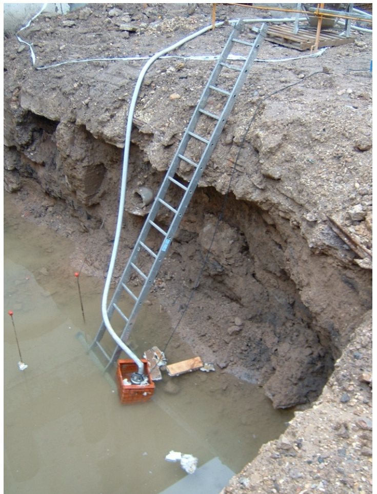
60.- Empleo de la bomba de achique para la extracción del agua del sótano.
