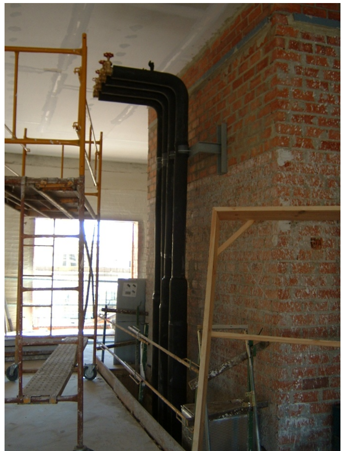
132.- Derivación de tubería de alimentación a unidades climatizadoras dejadas en previsión para la ampliación de las oficinas en la planta primera.
