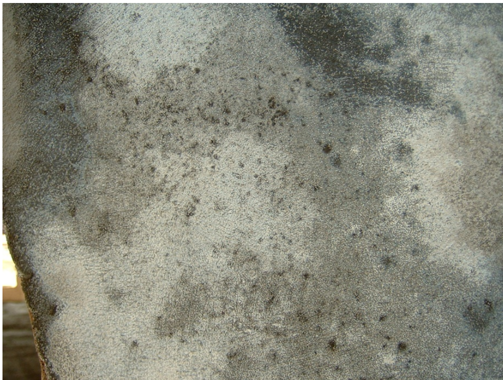
46.- Eflorescencias en el trasdós de la fachada tras la aplicación del revoco.
