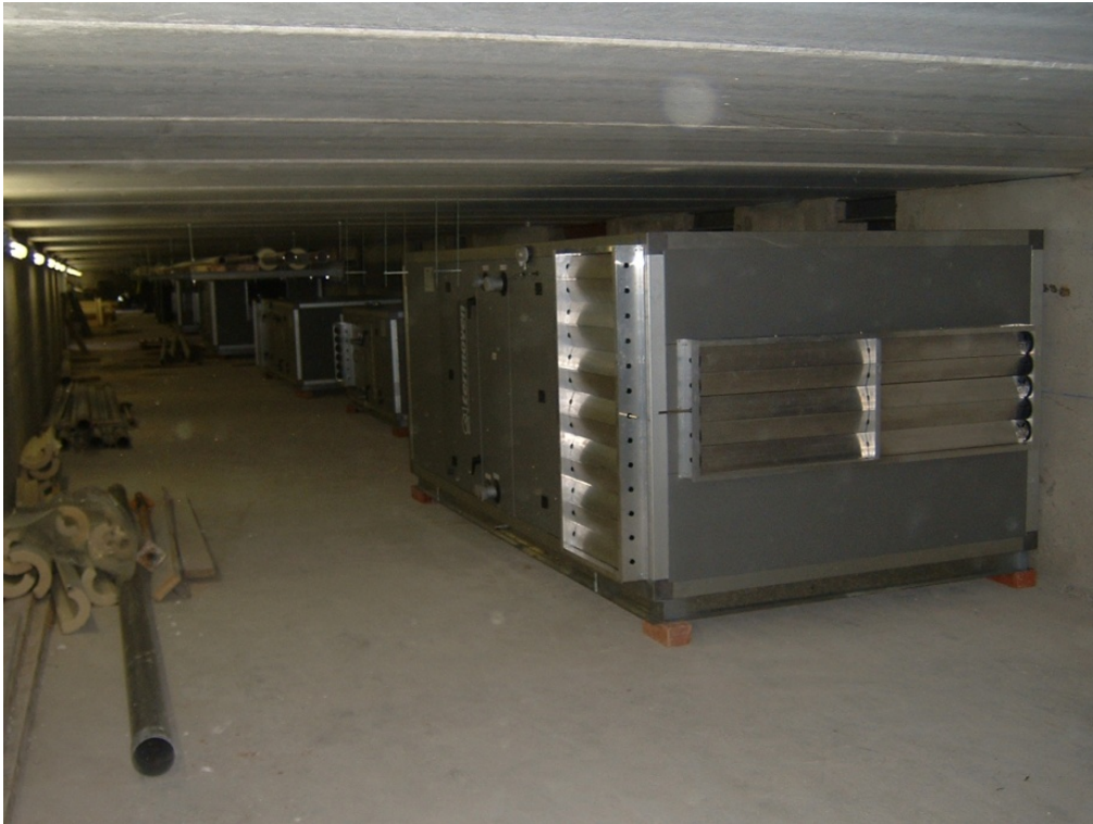
119.- Colocación de las unidades climatizadoras bajo el forjado de la plataforma de acceso al edificio.
