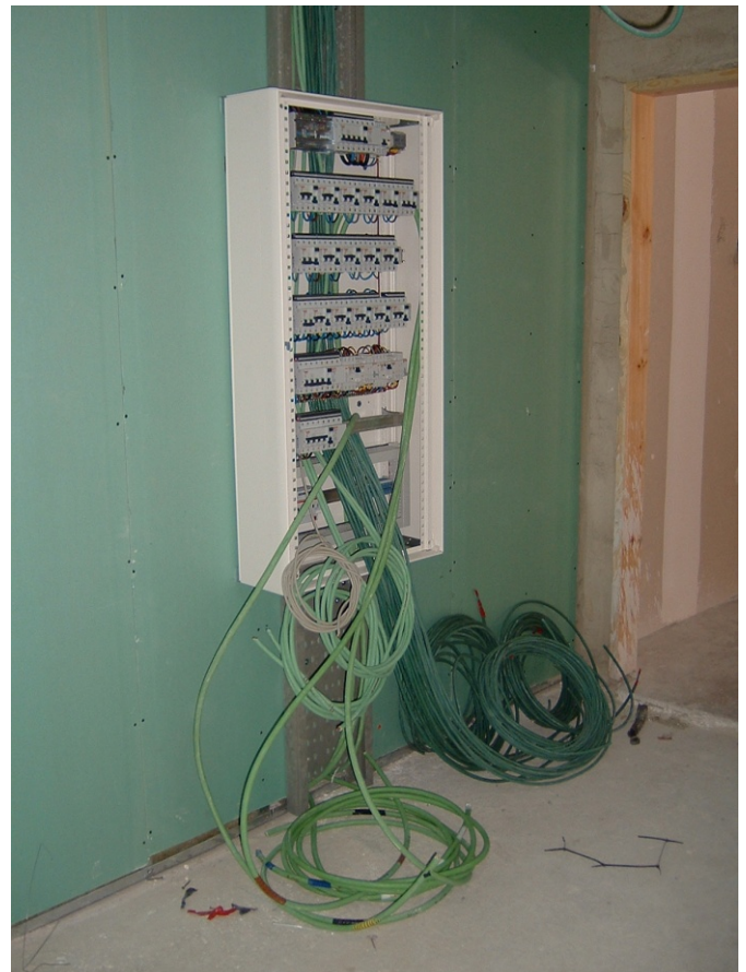
144.- Conexión de los cables de distribución de fuerza motriz en los cuadros de distribución.
