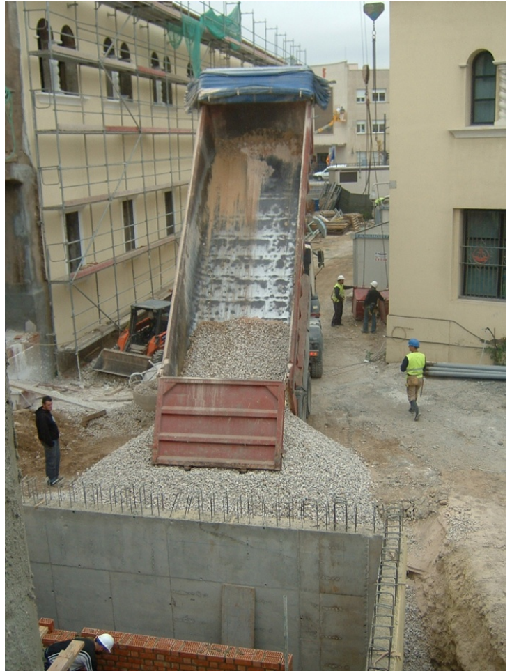
105.- Relleno con grava de los taludes del terreno dejados para la ejecución del sótano.
