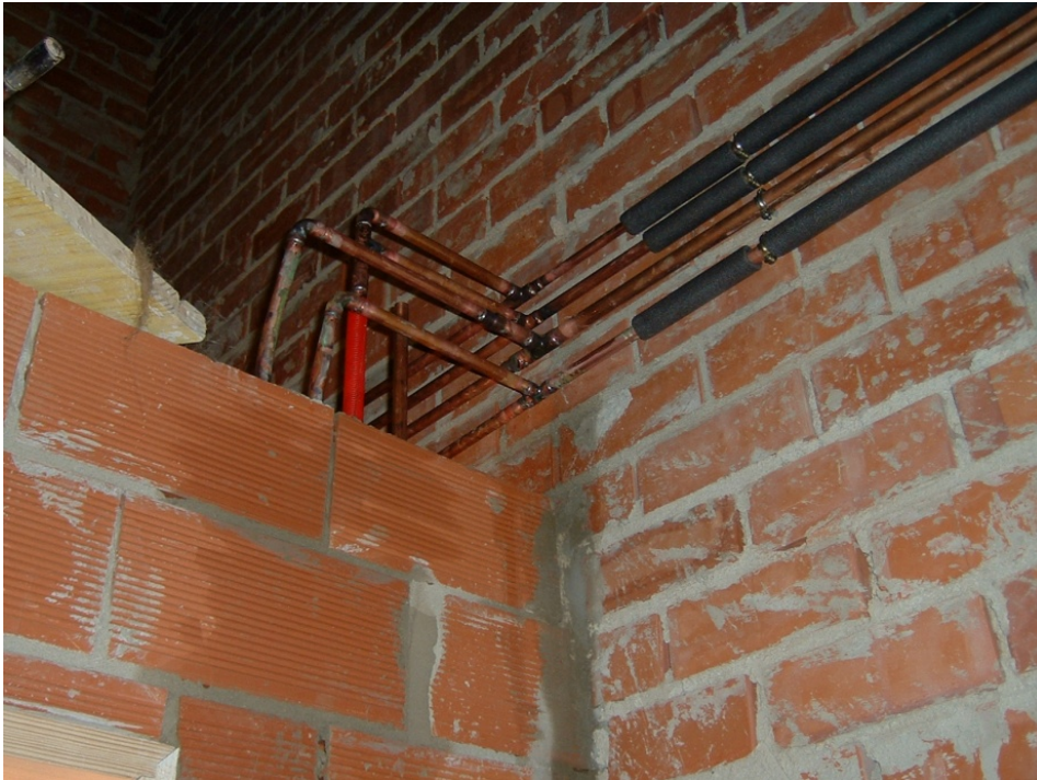
109.- Derivaciones individuales de tubería de cobre de la instalación de fontanería.
