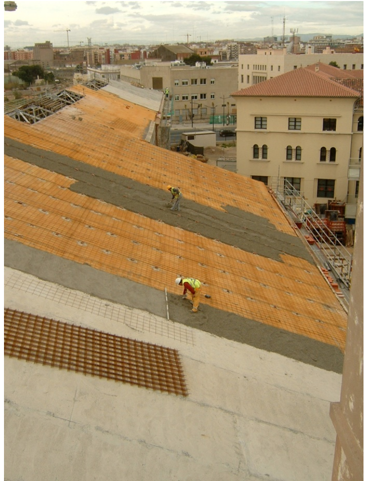
79.- Ejecución de la capa de compresión en los faldones de la cubierta.
