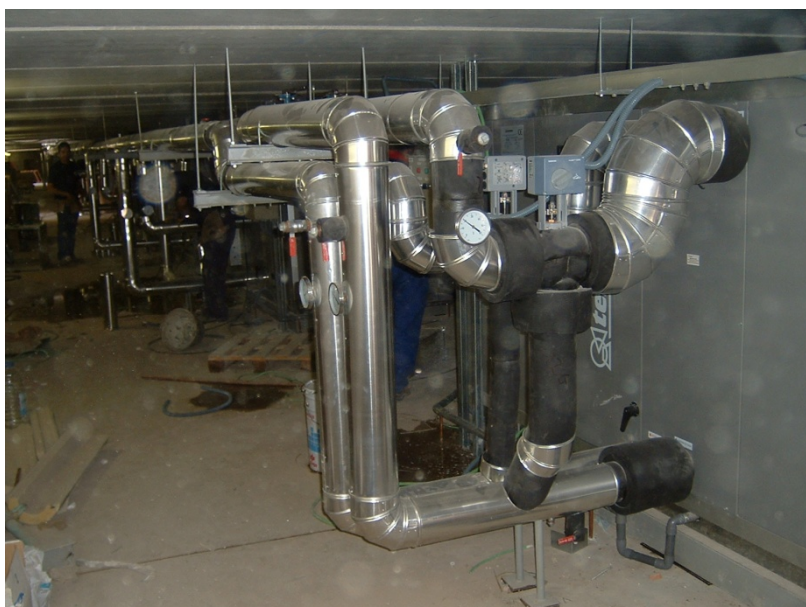
168.- Conexión de las unidades climatizadoras a la red de tuberías transportadoras de fluido caloportador.
