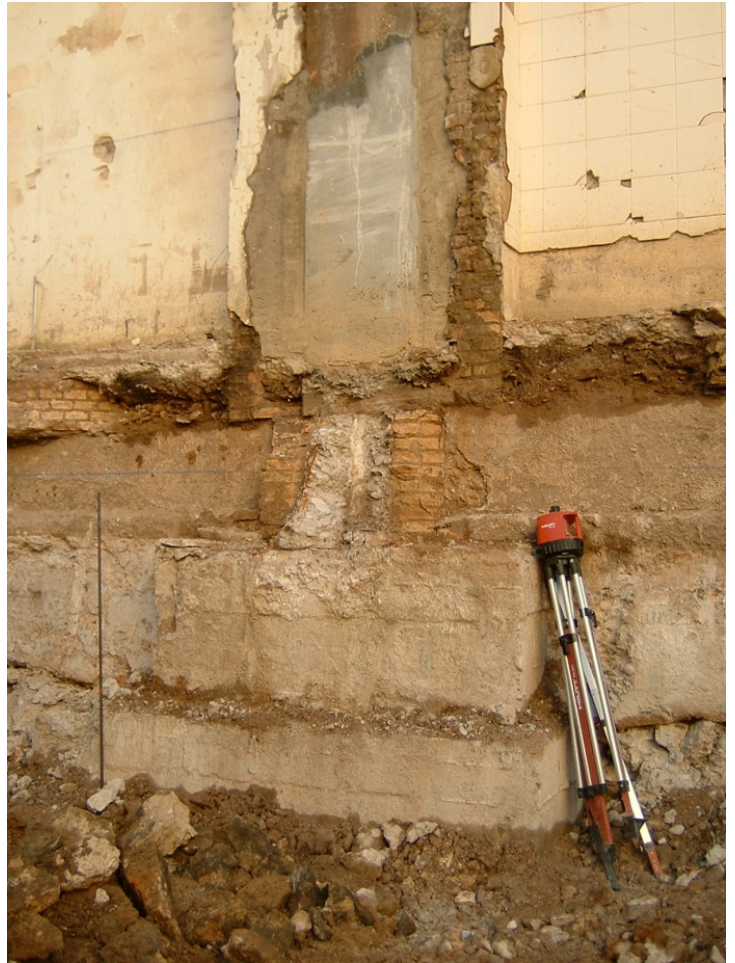
41.- Detalle de la cimentación de la nave, tras la excavación del sótano.
