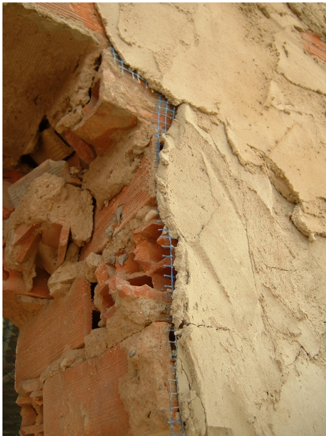
54.- Detalle de la aplicación del enfoscado de la fachada empleando malla de fibra de vidrio para evitar fisuraciones.
