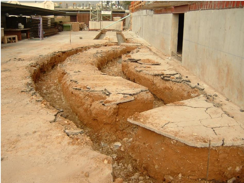
30.- Excavación de la cimentación para los muros de rampa y escalera de acceso a la plataforma exterior de entrada.
