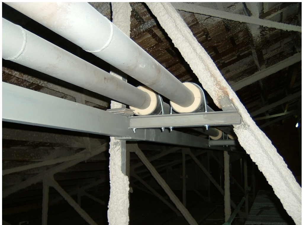
155.- Detalle de la sujeción de las tuberías de alimentación del sistema de climatización mediante abrazaderas de poliuretano.
