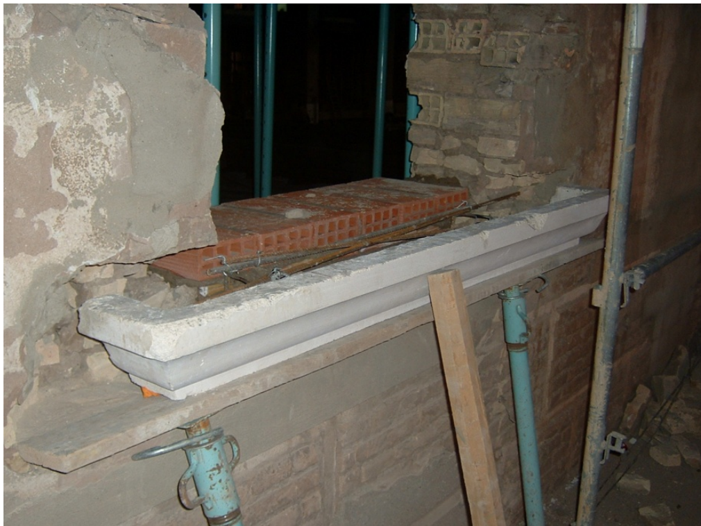
48.- Colocación de vierteaguas prefabricados en los huecos de fachada mediante anclajes metálicos en la fábrica de ladrillo.
