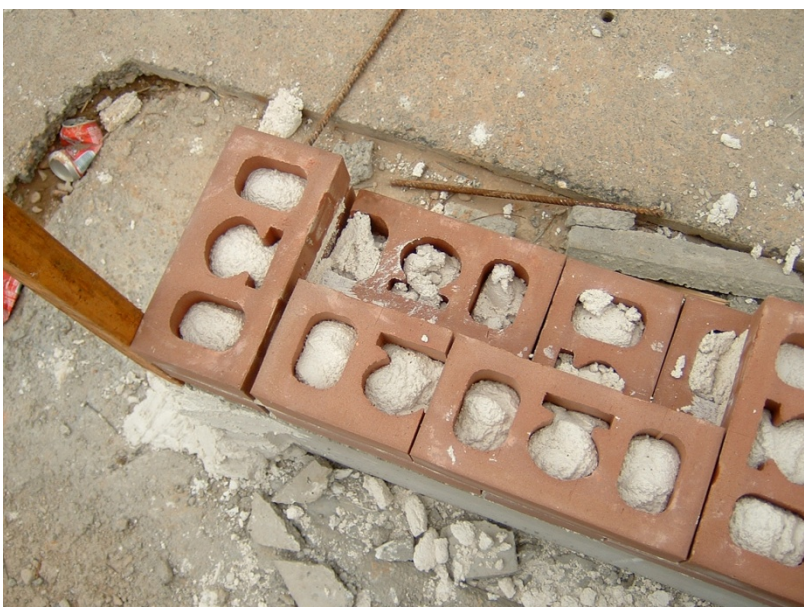
68.- Detalle del arranque de la fábrica de ladrillo caravista con aparejo flamenco de un pie.
