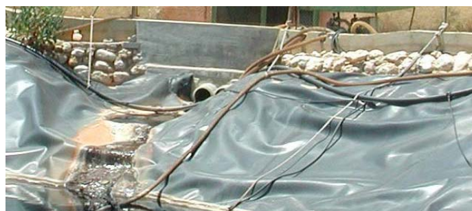
Imagen 3.4. Tubería de entrada de lixiviados a la balsa de lixiviados [8]
