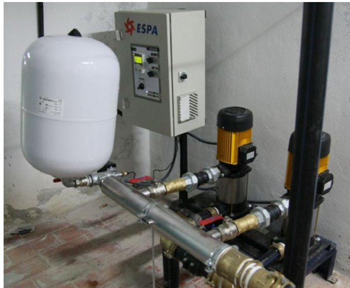
FIGURA A4-13. GRUPO MOTO-BOMBAS ORIGINAL DEL EDIFICIO
