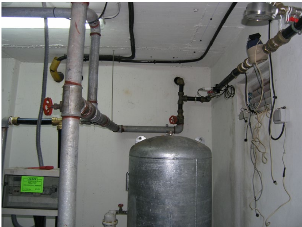
FIGURA A4-9. DETALLE CONTADOR GENERAL Y SONDA DE PRESIÓN CON DATA LOGGER
