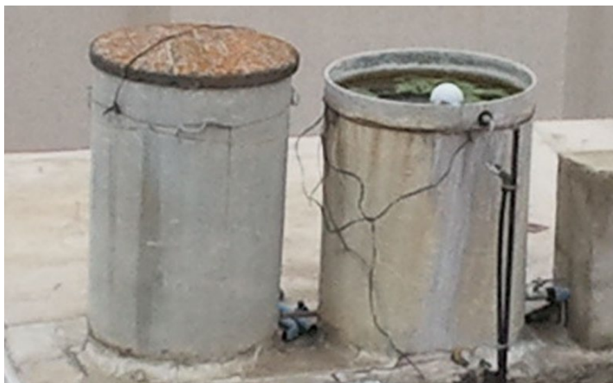
FIGURA C1-5. DEPÓSITO ATMOSFÉRICO SIN TAPA DE PROTECCIÓN
