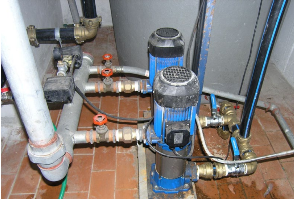
FIGURA A4-4. GRUPO MOTO-BOMBAS ORIGINAL DEL EDIFICIO
