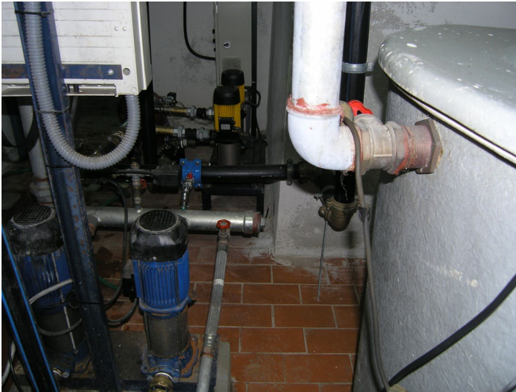
FIGURA A4-11. GRUPO DE PRESIÓN CON VARIADOR E INSTALACIÓN ORIGINAL (BOMBAS AZULES)
