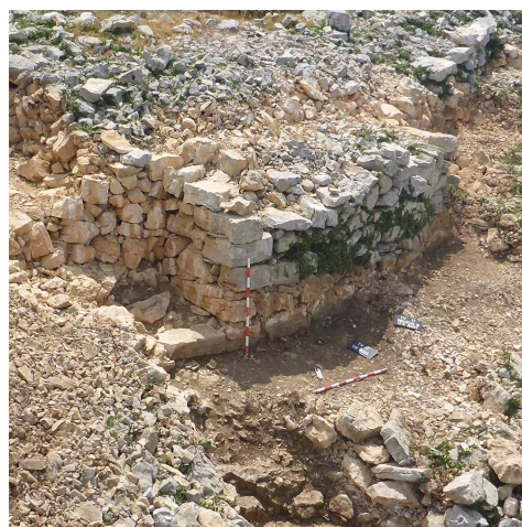
Fig. 3. Excavación del aterrazamiento de cimentación para la construcción de uno de los bastiones de la muralla (B1), articulado con el lienzo.
